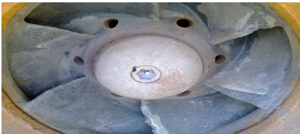
Figure II-5 :Vue proche d'une roue endommagée.
