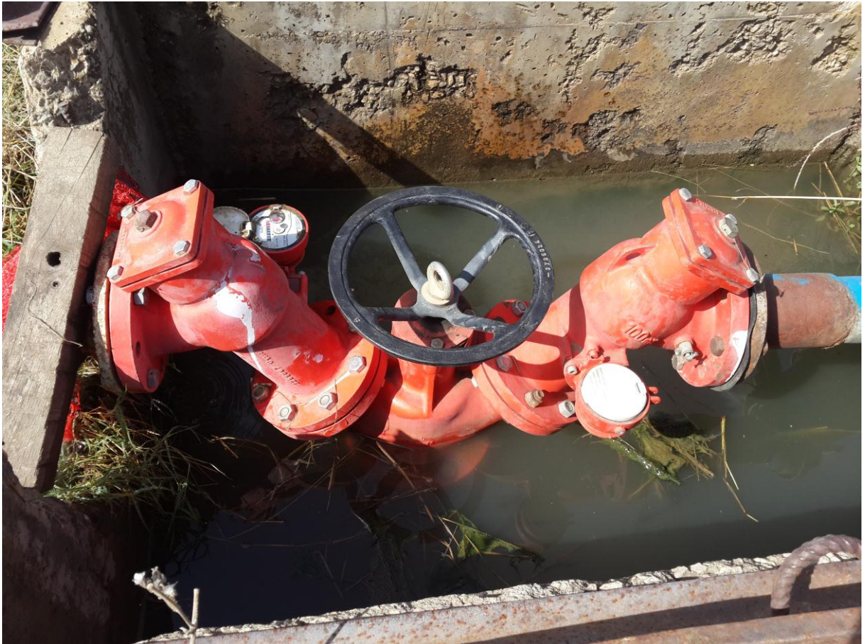
Figure N° V. 9 : Borne d'irrigation à deux prises à l'état actuel (24/08/2015)
