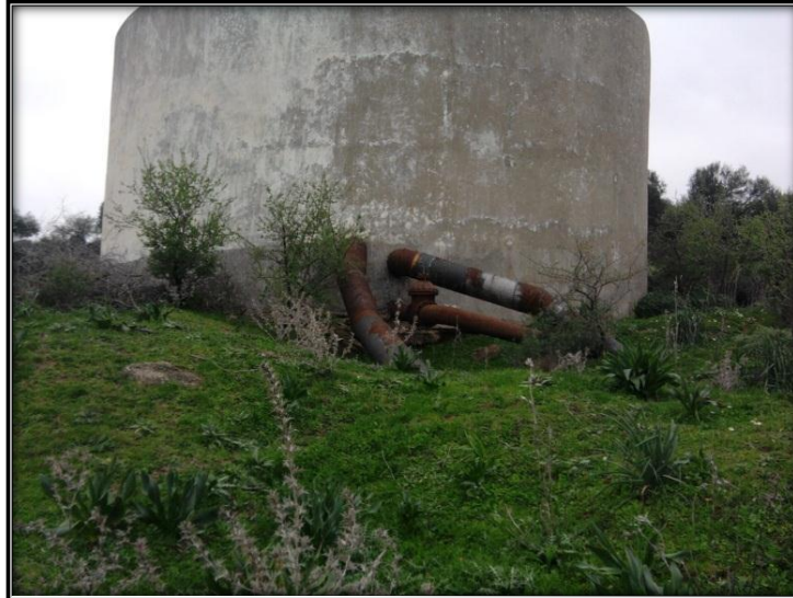
Figure IV-5 : Réservoir De Stockage
