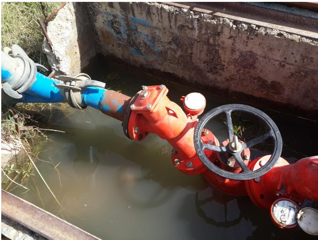
Figure VI. 2: Une borne d'irrigation a deux prises
