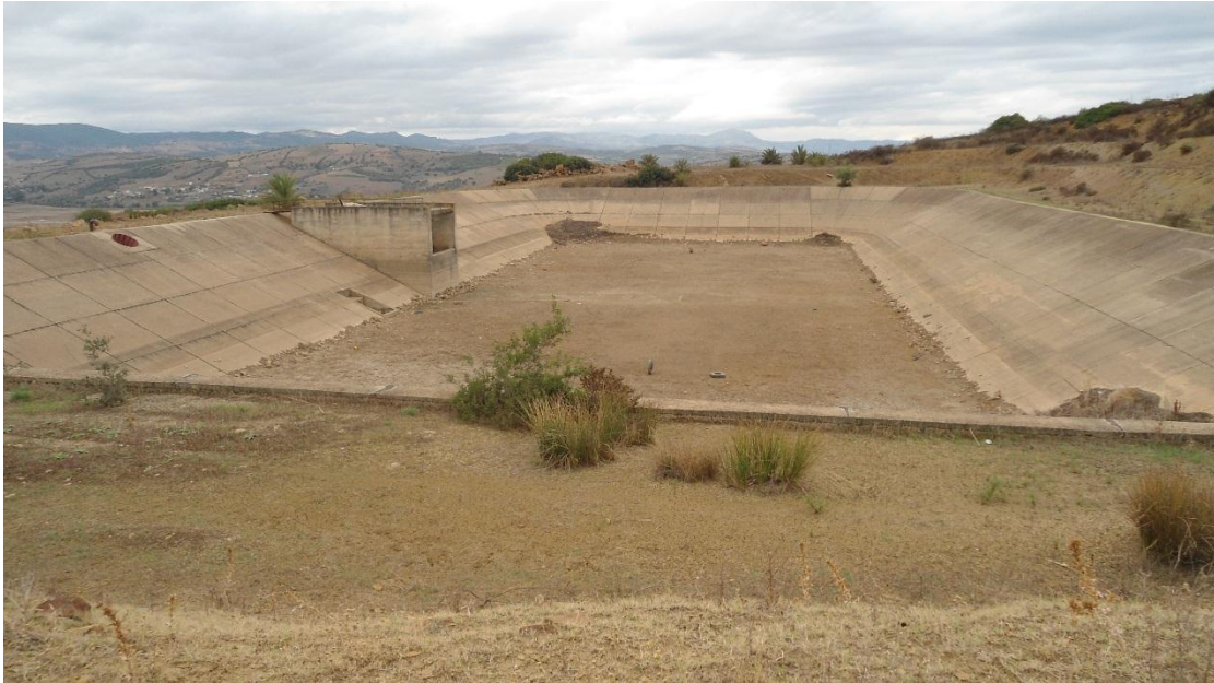
Figure VI. 1: Problème d’envasement du réservoir
