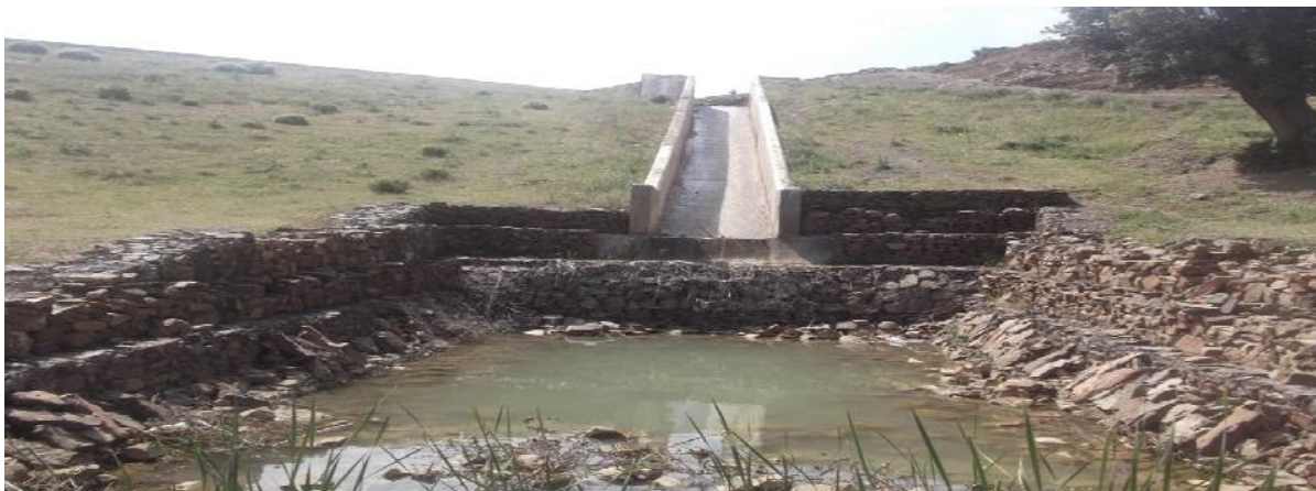
Figure N° III-3: vue de coursier et de bassin de dissipation de l'évacuateur de crue.
