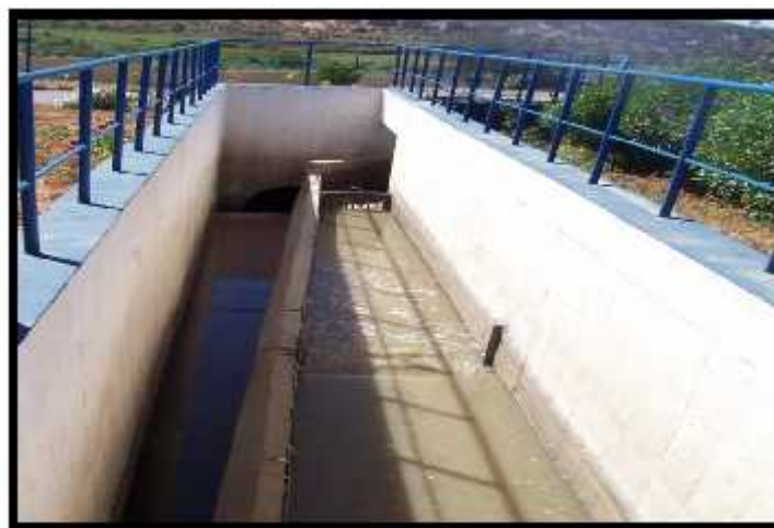
Photo III .2: Déversoir d'orage de la STEP d'AIN EL HOUTZ.
