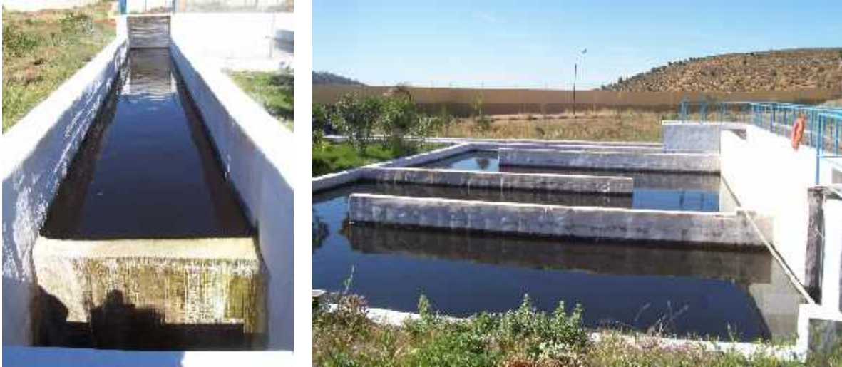
Photo III .7: Bassin de chloration de la STEP d'AIN EL HOUTZ.
