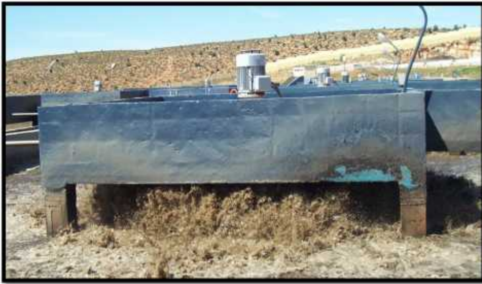
Photo III .5: Bassin d'aération de la STEP d'AIN EL HOUTZ.
