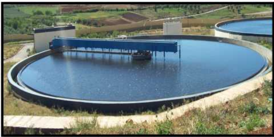
Photo III .6: Décantation secondaire de la STEP d'AIN EL HOUTZ.
