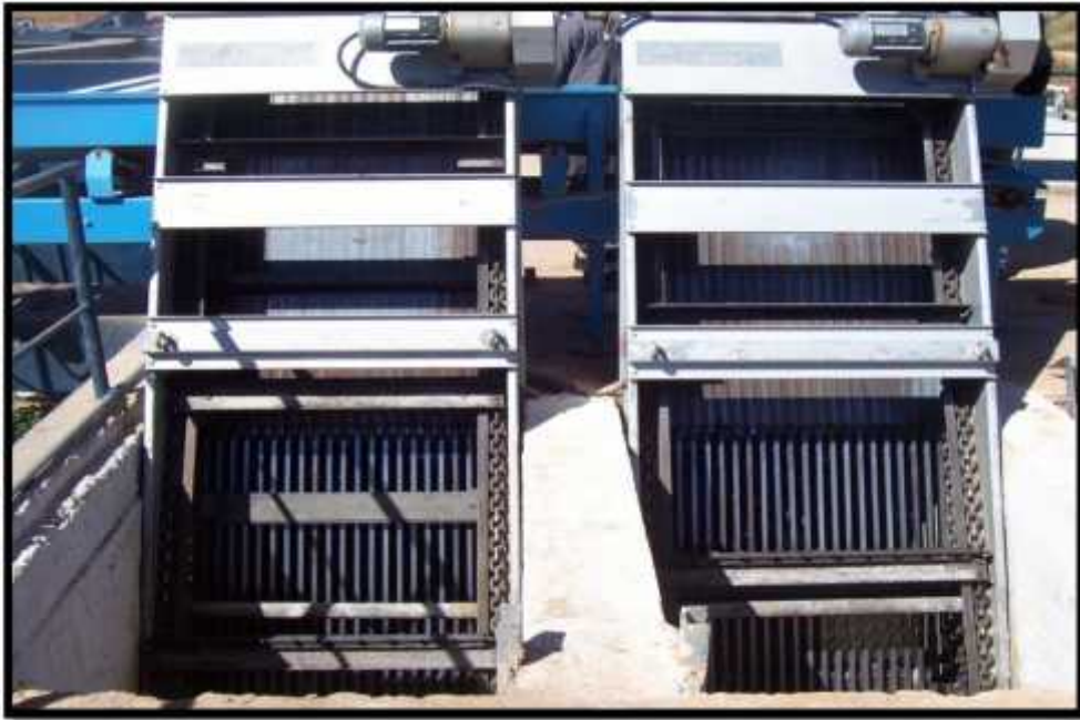
Photo III .3: Grilles mécanisées fine de la STEP d'AIN EL HOUTZ.
