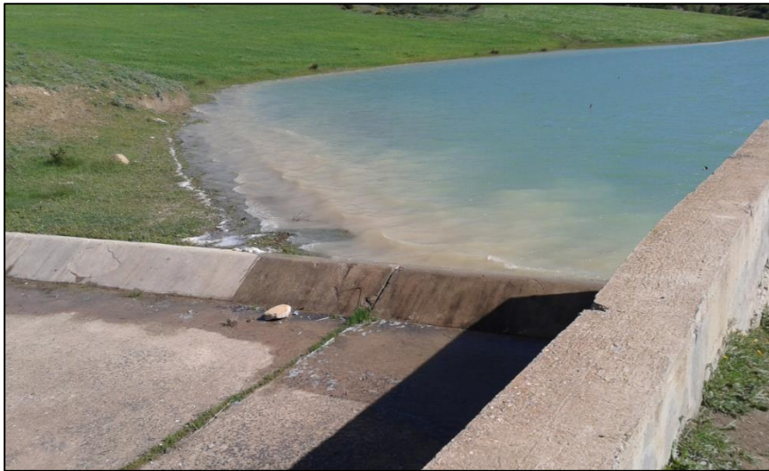
Figure II.5 : Vue l'état de l'évacuateur de crue (HYDRO PROJET, SARL .Décembre2015)
