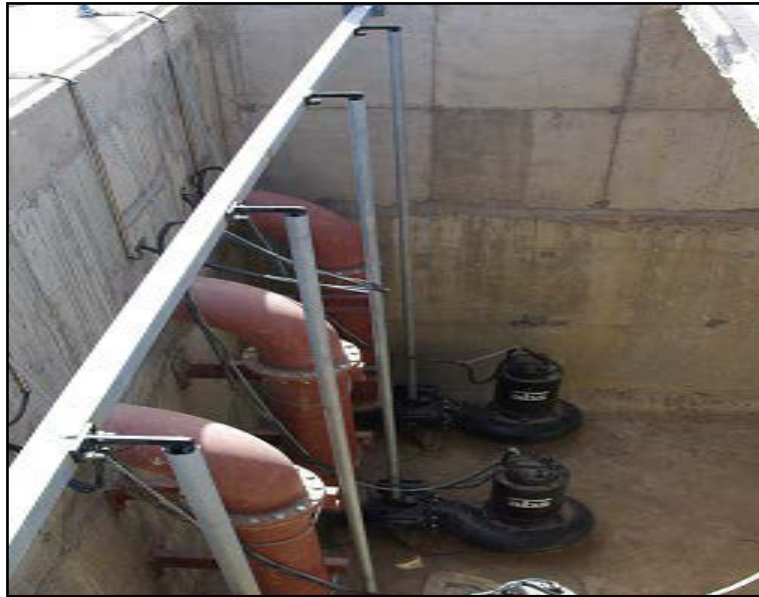
Figure III-04 : Photo Réelle de l'installation de pompage.
