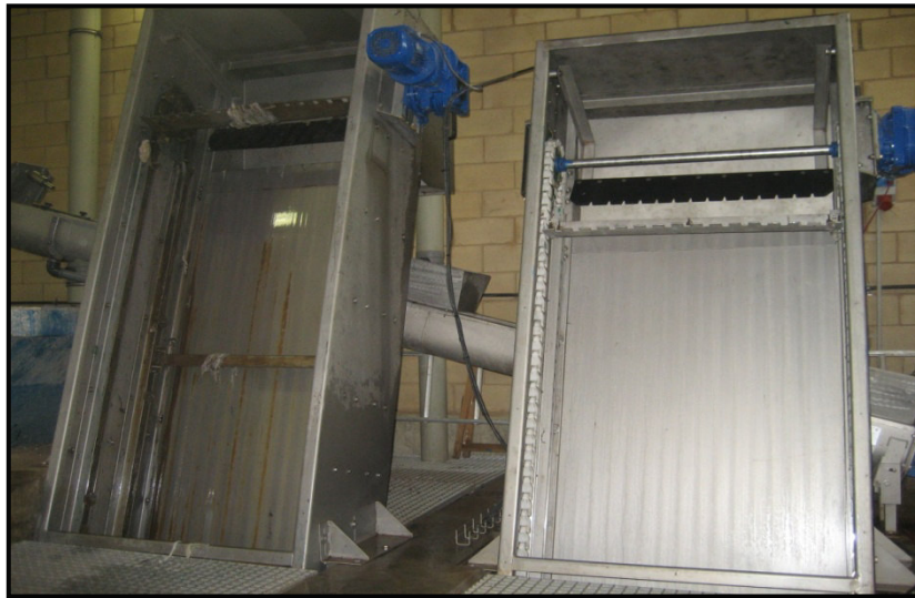
Figure III-03 : Photo Réelle du dégrilleur.
