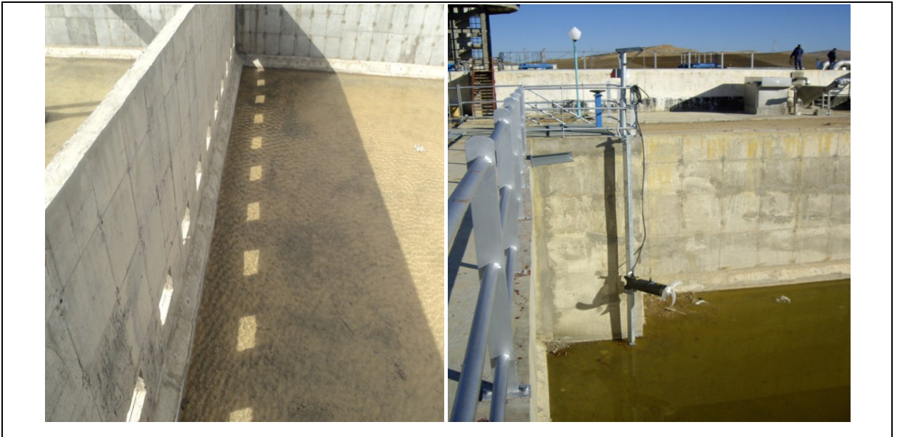
Figure III-06 : Photo Réelle des agitateurs zone anoxique.
