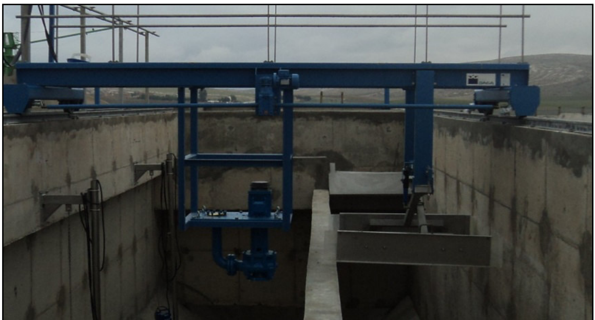
Figure III-05 : Photo Réelle système dessablage et déshuilage.
