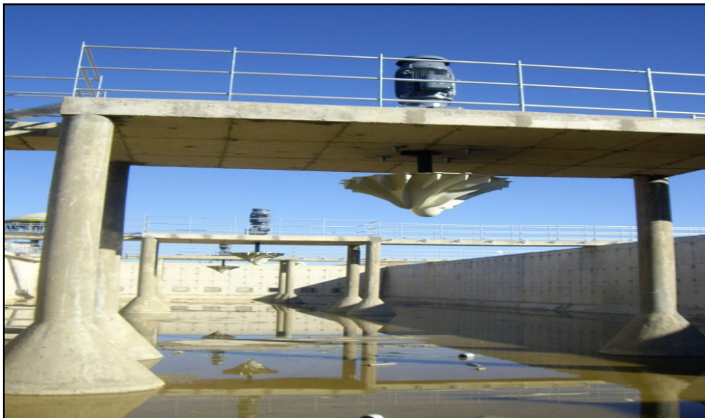
Figure III-07 : Photo Réelle de l'aérateur zone oxique.
