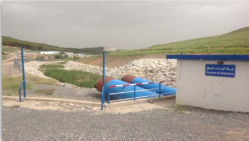
Figure III. 2: Conduites de distribution pour l'irrigation.
