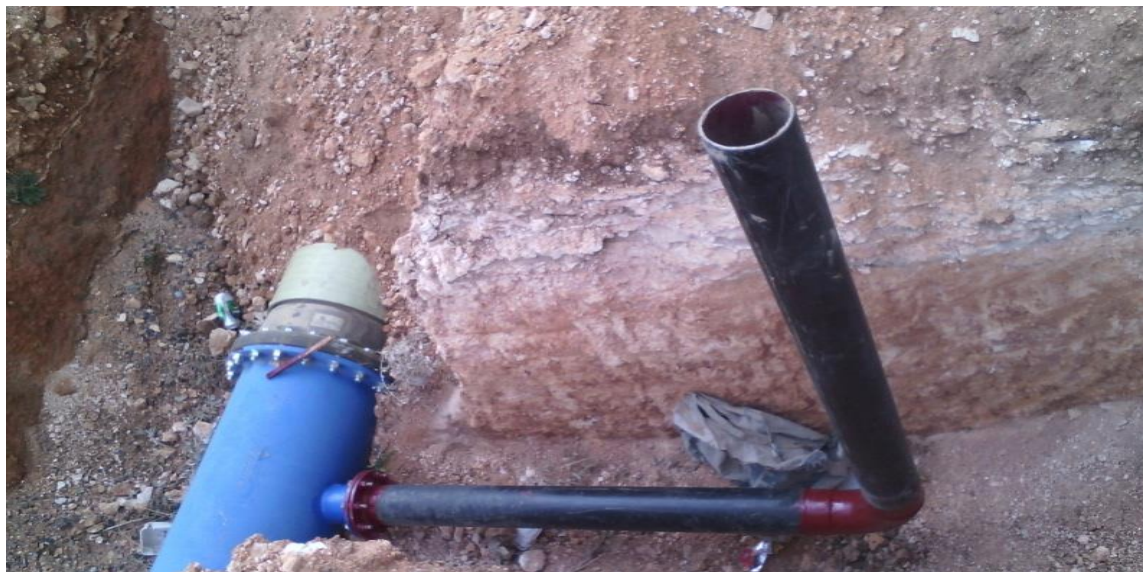
Figure VIII-2 : Picage d'une conduite secondaire à une borne d'irrigation (Périmètre Haut Isser Avril 2016)
