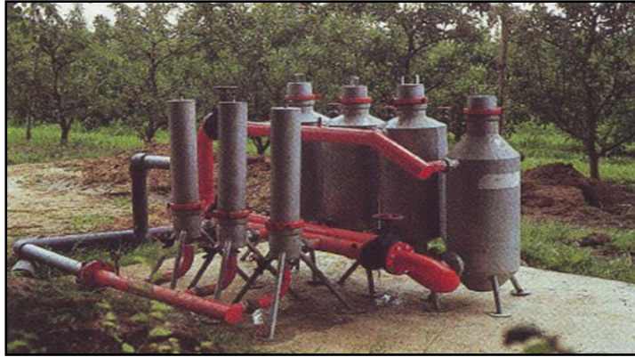
Figure VI.3 : Filtres à tamis.
