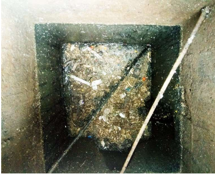
Figure 5-10:vue sur le regard de réception de poste de relevage existant (sr5) (Source : Bureau d'études AH2E / juin 2020)
