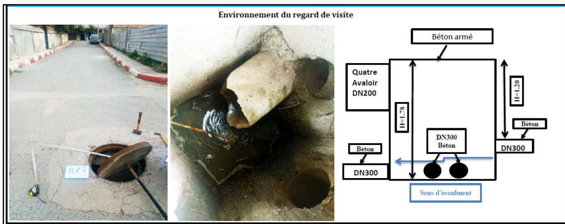
Figure 5-5: Regard R77 présence des déchets solides (Source : Bureau d'études AH2E / juin 2020)
