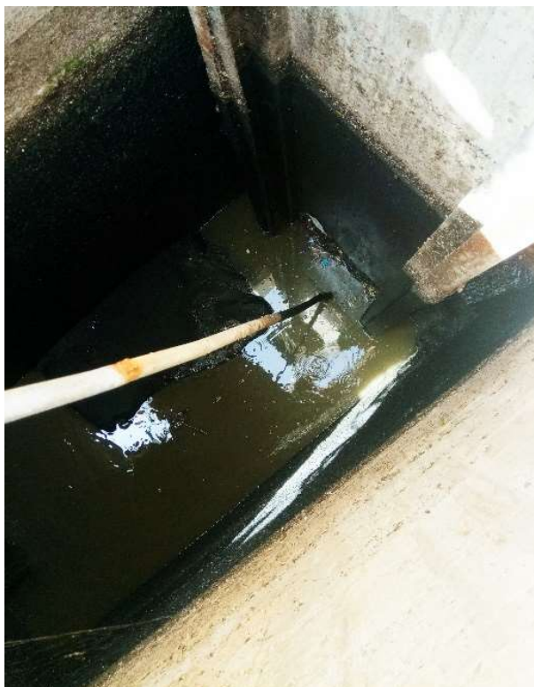
Figure 5-11:vue sur l'état de dégrilleur(SR5). (Source : Bureau d'études AH2E / juin 2020)
