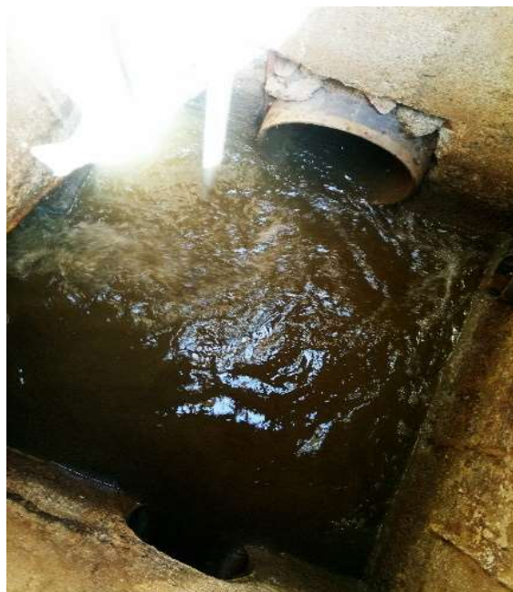
Figure 5-8:vue sur le regard de réception de station de relvage SR04. (Source : Bureau d'études AH2E / juin 2020)
