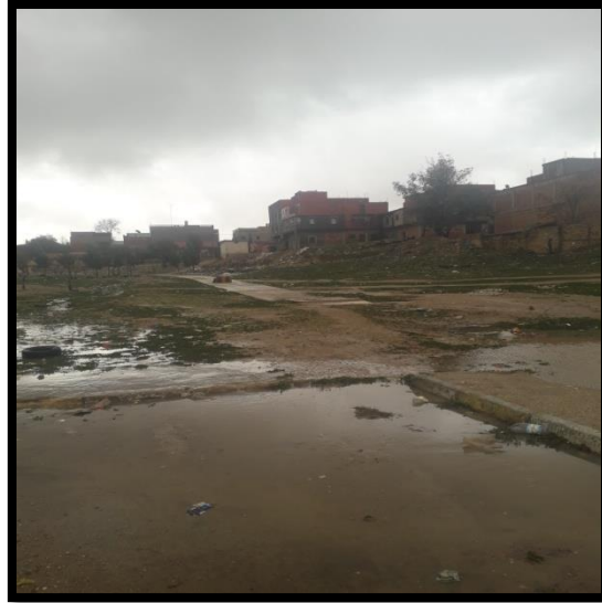
Figure III -2 : Sondage Galerie existante de section= b*h=2*1.80 (Partie défectueuse) à HAY AOUED BAGHDAD (Source : DRE)
