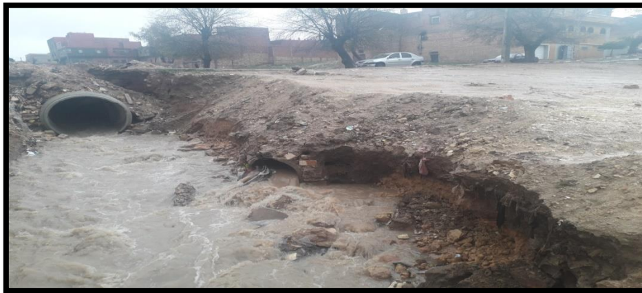
Figure III -5 : Conduite DN800 CAP appartient de hay Centre-Ville en état dégradé branché dans la galerie défectueuse (Source : DRE)
