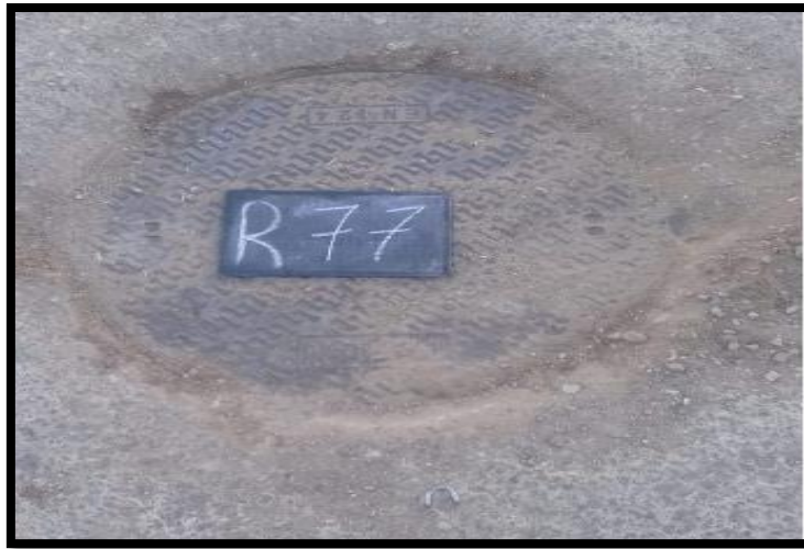
Figure III -8 : regard n°77 avec tampon fixe
