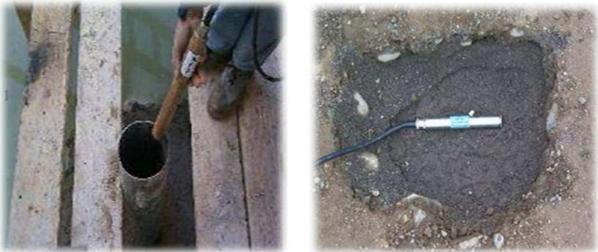
Fig. N°19. Piézomètre électrique à corde vibrante
