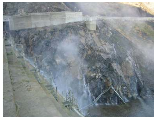
Fig. N°4: Infiltrations dans la rive gauche avant les travaux du drainage et d'injection
