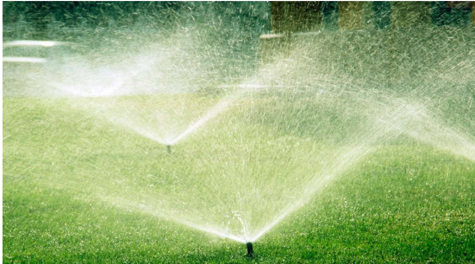
Figure VII.2 : Irrigation par aspersion
