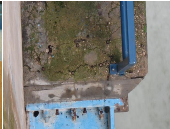
Figure III.29: Dégradation de la zone d'appui
