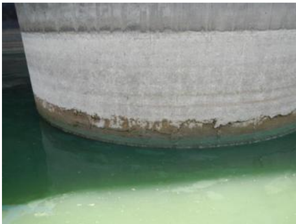
Figure III.22: Dégradation du béton dans la zone de marnage
