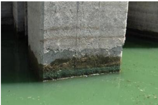
Figure III.35: Altération du béton dans la zone de marnage
