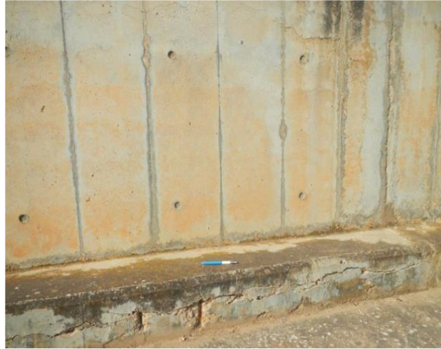
Figure III.7: Fissures au niveau du pied du parapet amont
