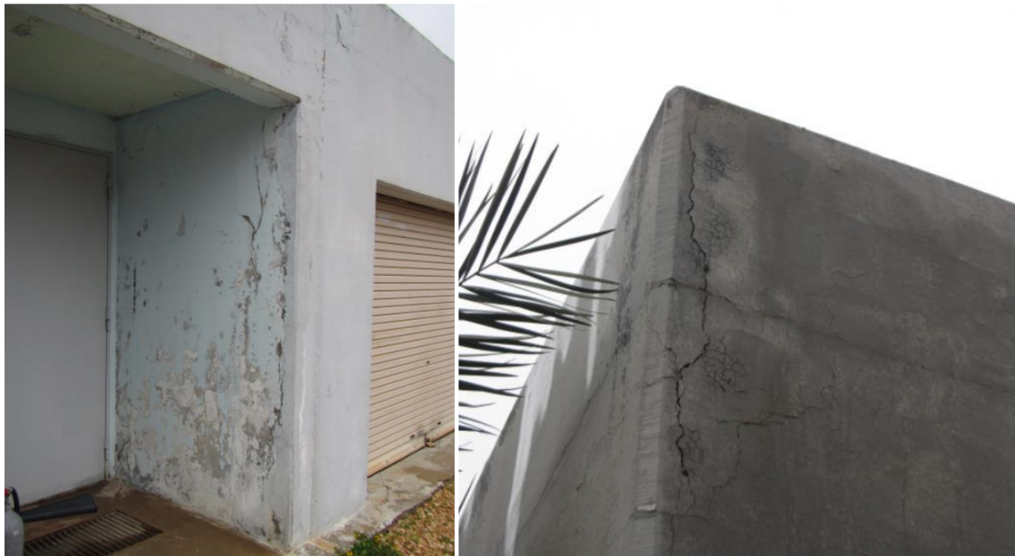
Figure III.11: Fissures visibles au niveau de la structure sur le bâtiment EG
