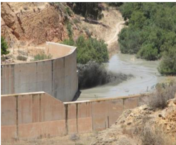
Figure III.39: Ouverture de vidange (écoulement vaseux).
