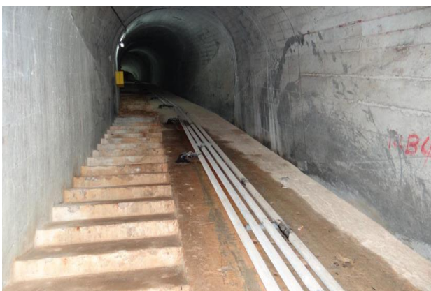
Figure III.18: Galerie humide en raison du réseau de drainage en mauvais état.
