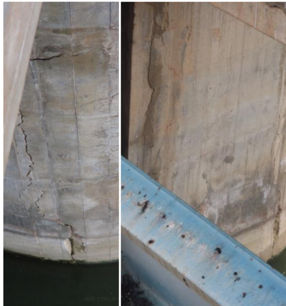
Figure III.26: Fissures au niveau de l'entonnement de la passe 4
