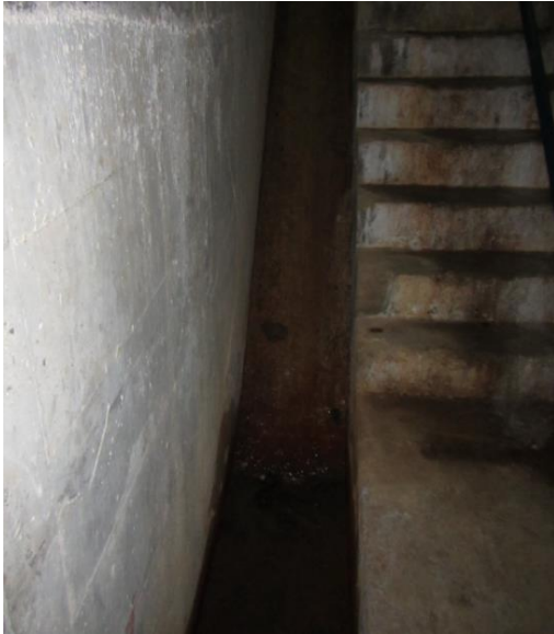
Figure III.16: Ruissellement au niveau de la porte d'accès parement aval
