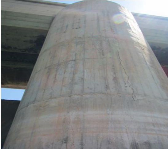
Figure III.24: Fissure en hauteur pile 4
