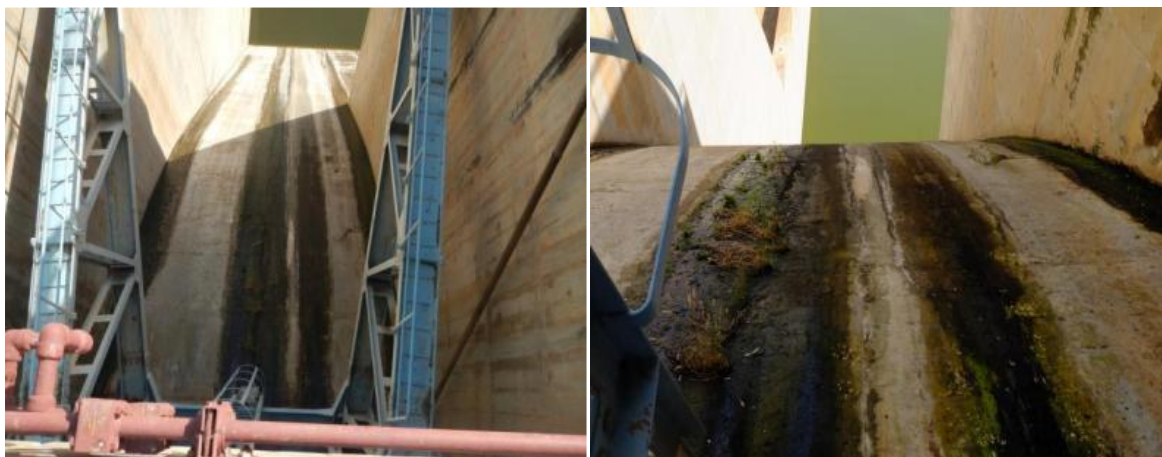
Figure III.30: Mousse et dégradation de surface du béton - vanne secteur 1 - plot 5-6
