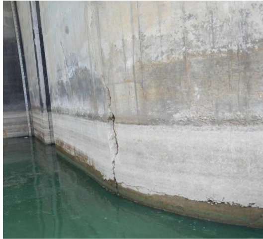
Figure III.25: Dégradation amont pile 5
