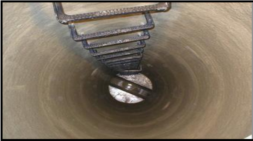
Figure VI-11 : Regard de visite.
