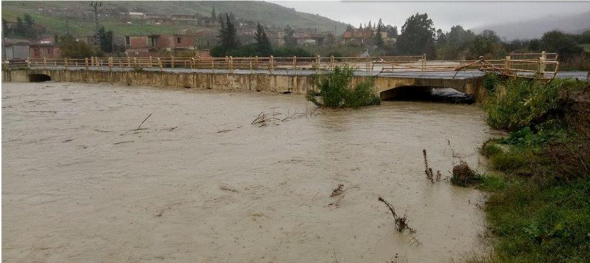
Figure n° I 13 L'ouvrage existant c'est un ouvrage submersible ainsi que la section mouille insuffisante
