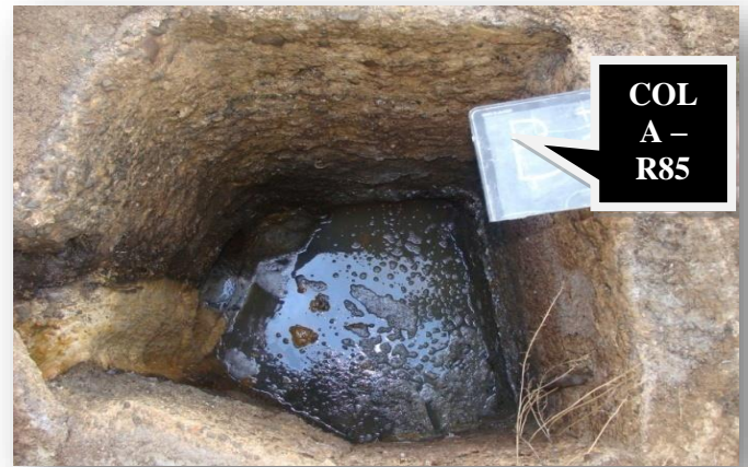
Figure V-11: Regard de branchement (hors norme).2015 Planche de réseau existant : Collecteur A-R85
