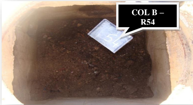
Figure V-3: Regard de visite (bouchée).2015 Planche de réseau existant : Collecteur B-R54
