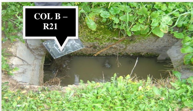
Figure V-12: Regard de visite (hors norme).2015 Planche de réseau existant : Collecteur B-R21
