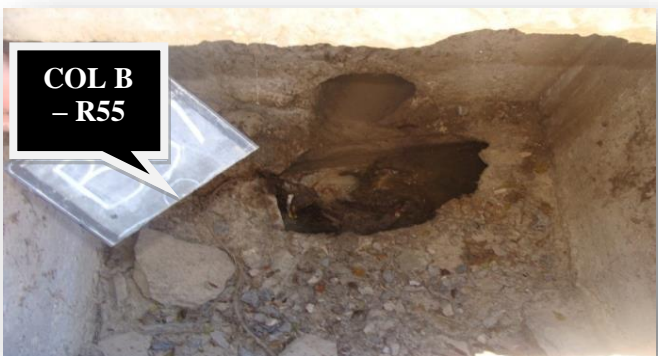
Figure V-8 : Regard de visite (hors norme).2015 Planche de réseau existant : Collecteur B-R55
