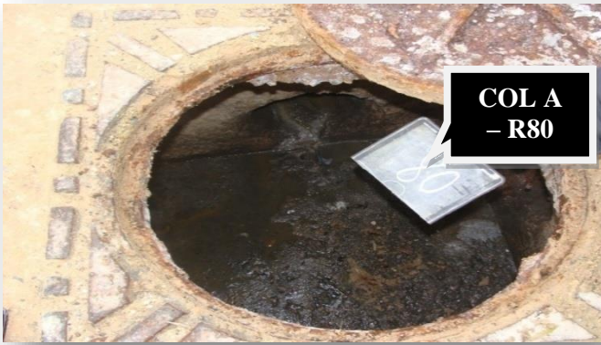
Figure V-1: regard de branchement (colmatée).2015 Planche de réseau existant : Collecteur A-R80
