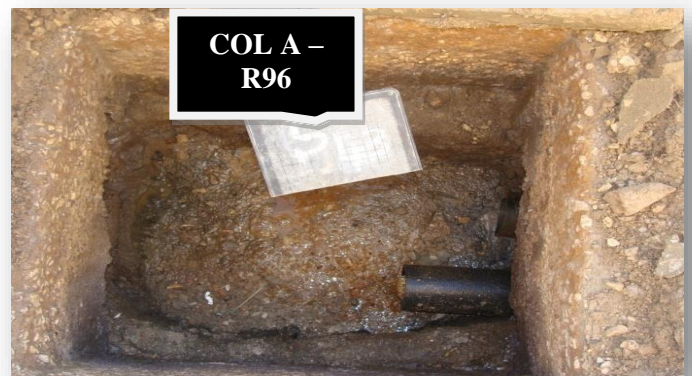
Figure V-7: Boîte colmatée.2015 Planche de réseau existant : Collecteur A-R96
