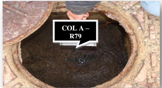
Figure V-4: Regard de branchement (colmatée).2015 Planche de réseau existant : Collecteur A-R79
