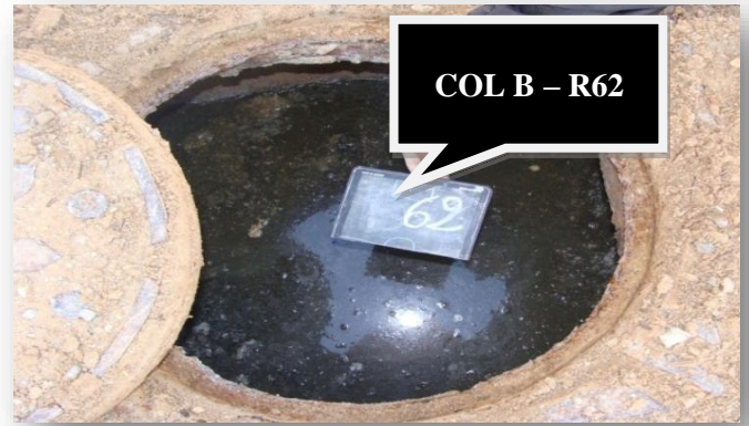
Figure V-2: Regard de visite (colmatée).2015 Planche de réseau existant : Collecteur B-R62
