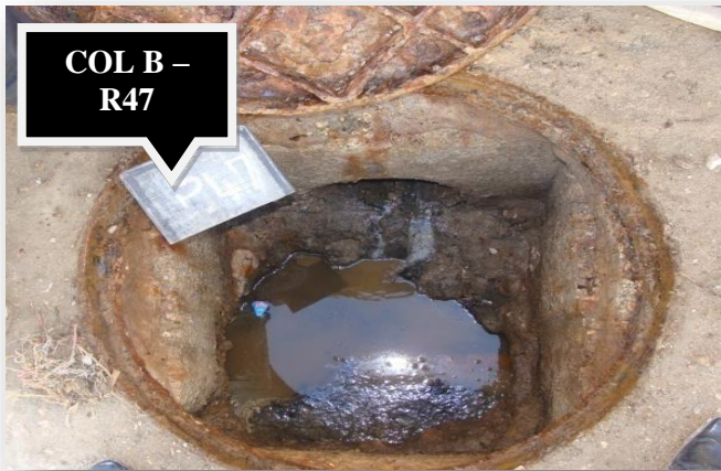
Figure V-10 : Boite de branchement (état dégradée).2015 Planche de réseau existant : Collecteur B-R47
