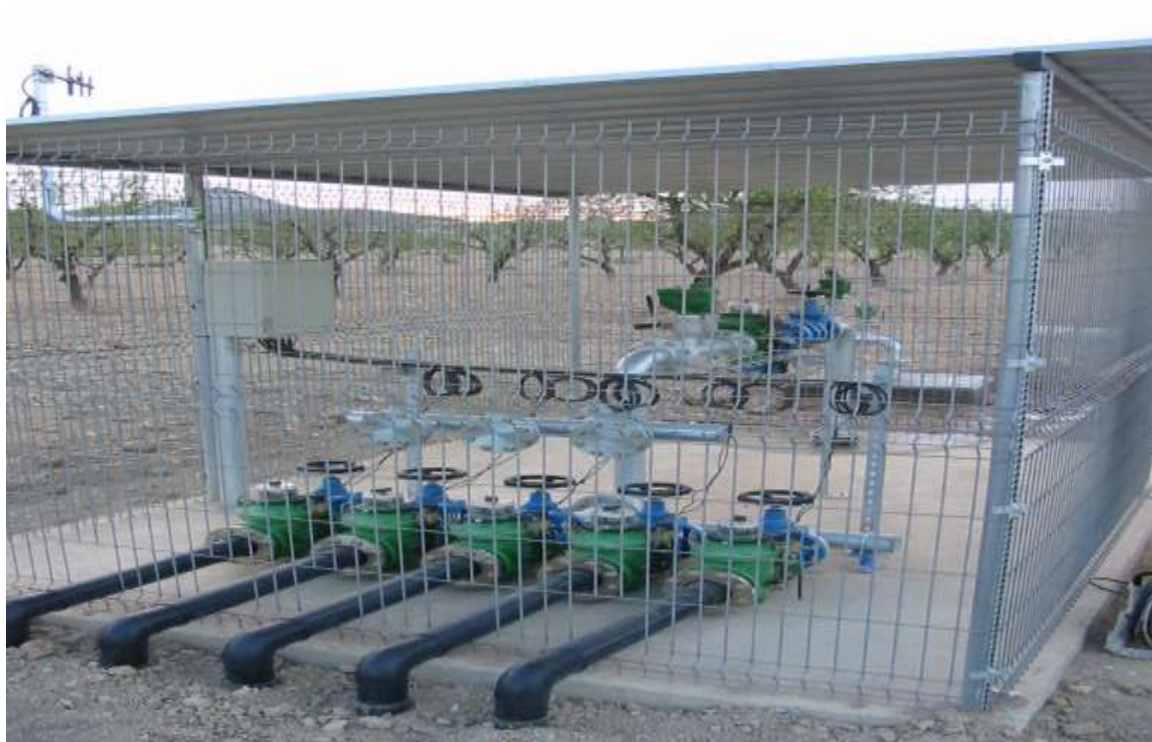
Figure VII-3: Photo d'une borne d'irrigation
