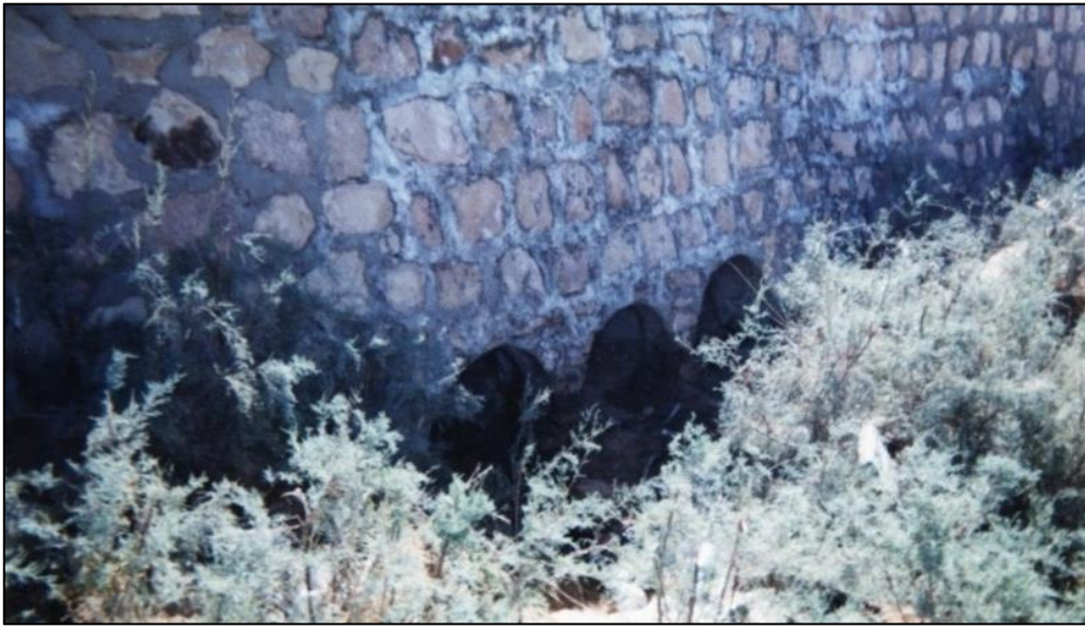
Figure VI.9 : Passage busé colmaté.
