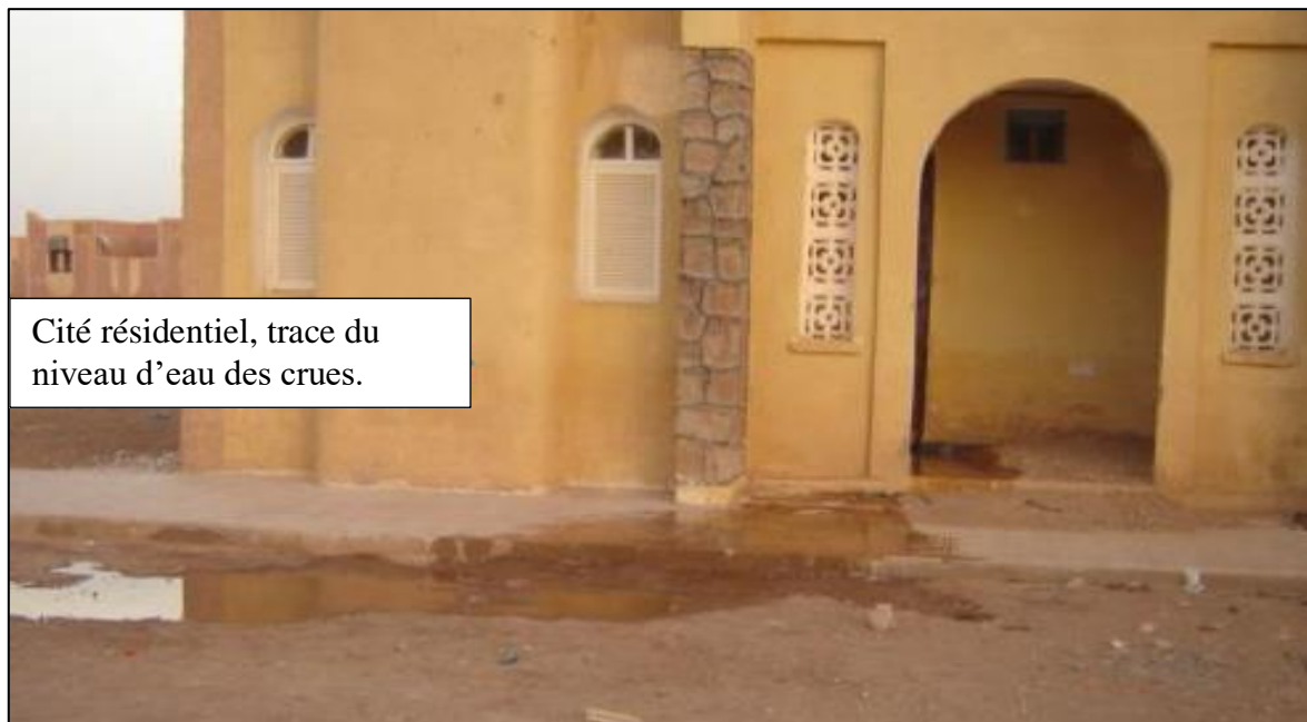
Figure II.5 : Une trace du niveau d'eau de l'inondation, Cité résidentiel.
