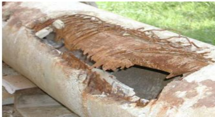
Fig. 3.8. Conduite en béton armé détériorée par la corrosion
