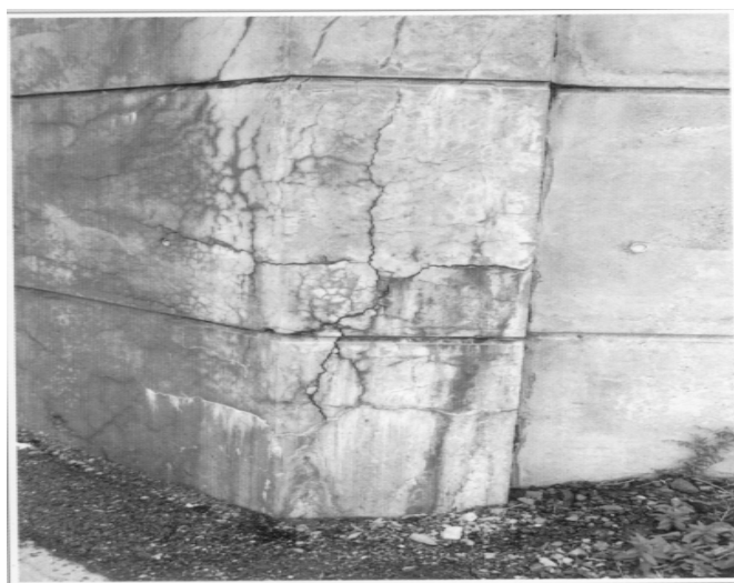
Fig. 3.9. Béton fissuré suite à une Alkali Silice Réaction.
