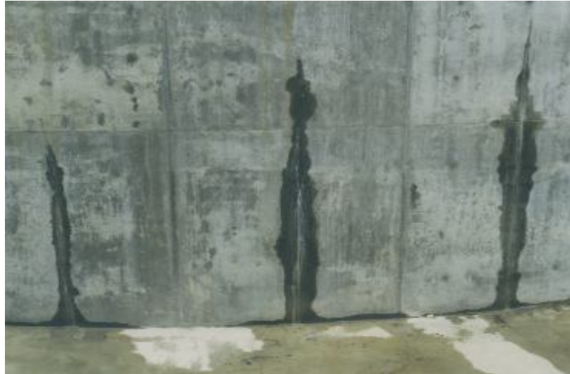
Fig. 3.3. Fissures de retrait thermique empêché dans un voile en béton d'un réservoir.
