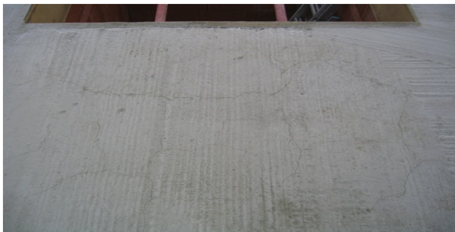
Fig. 3.2. Fissuration superficielle due au retrait plastique
