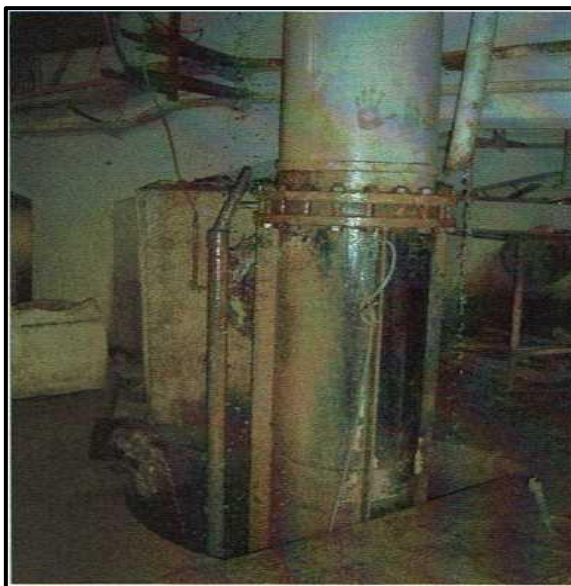
Figure 13 : SP Khemis II - Lubrification des paliers à l'eau brute
