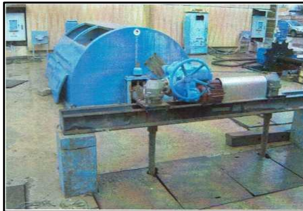
Figure 10 : SP Khemis II - Vanne murale et filtre à bande
