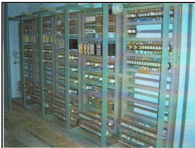
Figure 21 : SR - Automatisme en cellules ouvertes
