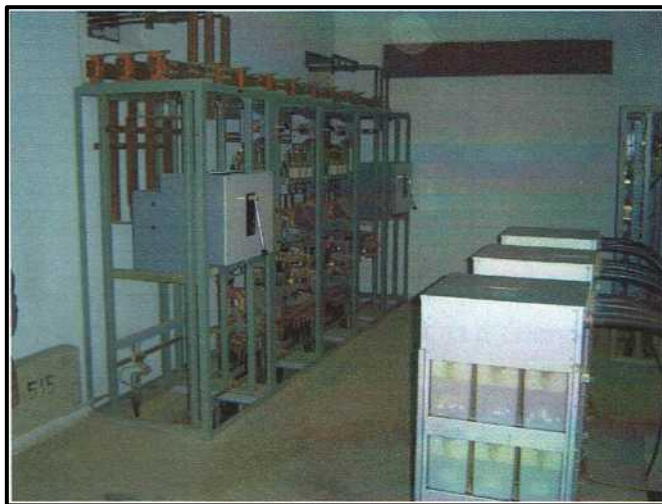
Figure 20 : SR -Matériel électrique BT en cellules ouvertes
