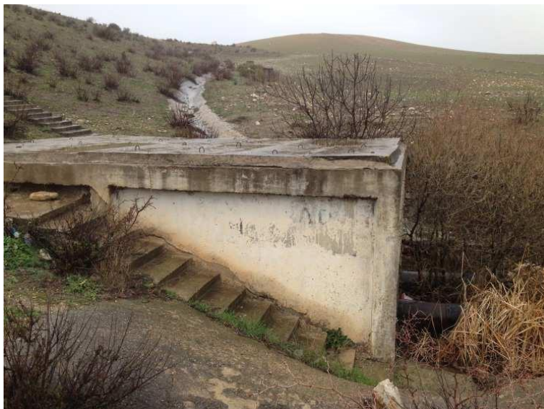
Figure II.19: Chambre de manœuvre aval (ISL, 2015)
