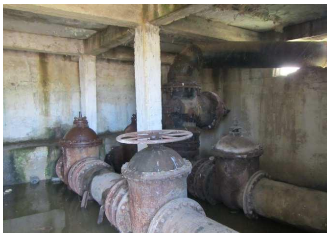
Figure II.22: Vidange de fond et prise d'eau (ISL, 2015)
