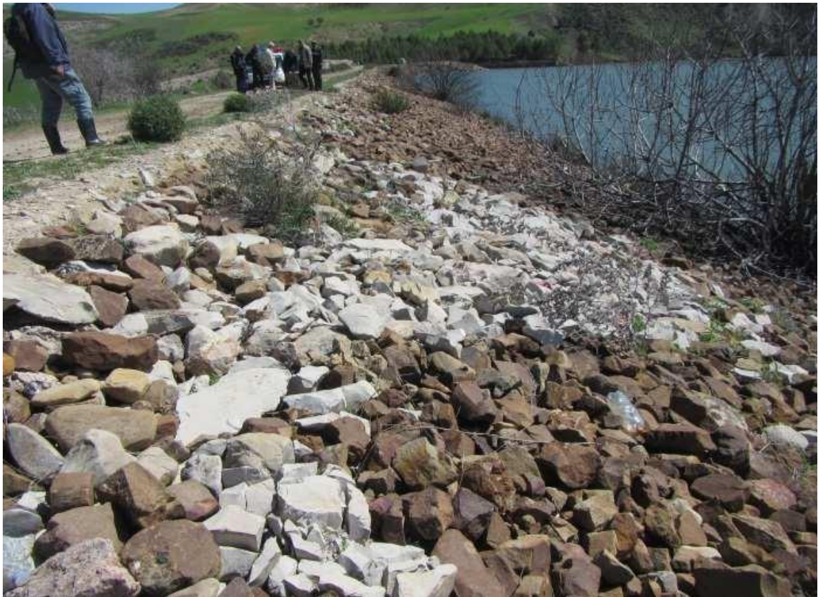
Figure II.2: Zone à enrochements différents en haut de talus RG (ISL, 2015)
