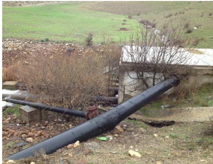
Figure II.23: Départ conduite prise d'eau RG chambre (ISL, 2015)
