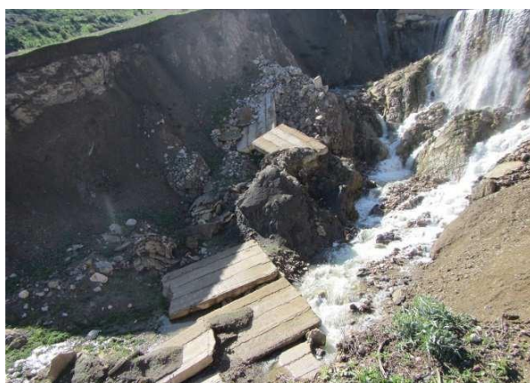
Figure II.17 : Eléments du coursier détruit (ISL, 2015)
