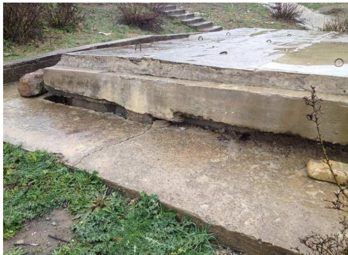
Figure II.20: Tassement remblai autour de la chambre (ISL, 2015)
