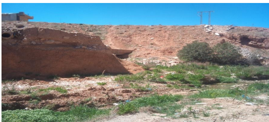
Figure n°IV.3 Glissement du talus d'Oued T'kout au niveau de la zone 2.
