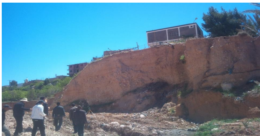
Figure n°IV.2 Glissement du talus d'Oued T'kout au niveau de la zone 1.
