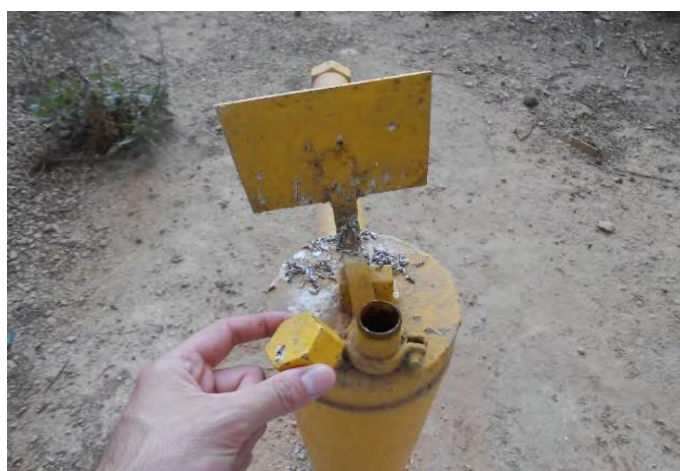
Figure II.30 : Détails d'un piézomètre Ouvert situé aux pieds des voutes.
