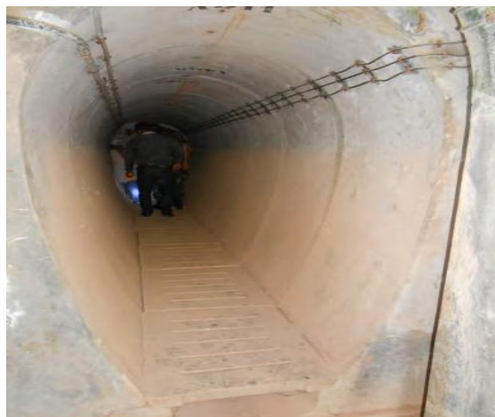
Figure II.21 : Galerie au pied amont du barrage.
