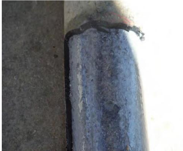
Figure III.58 : Voûte 13-14 - Câble 20 – Présence d'eau entre le coulis d'injection et la gaine.
