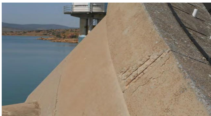
Figure II.15 : Eclat du béton et armatures corrodées.
