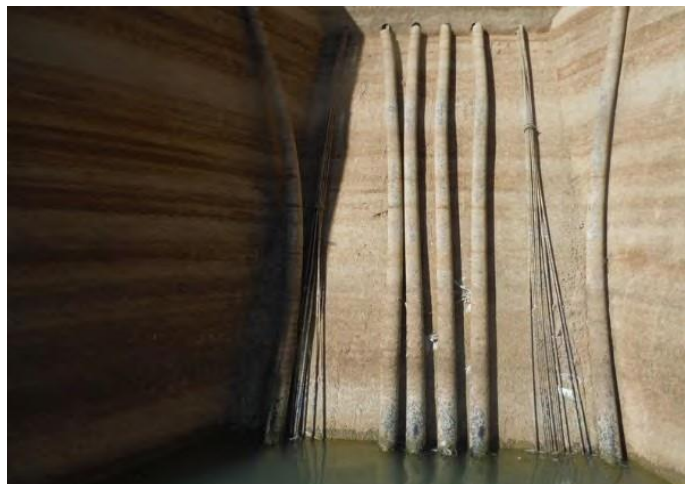
Figure III.53 : Câbles gainés présentant une courbure.
