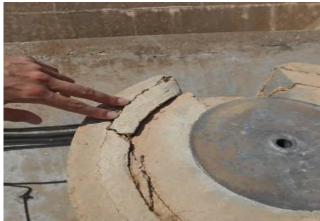
Figure II.28 : Détail du mauvais état de conservation des piliers topographiques.
