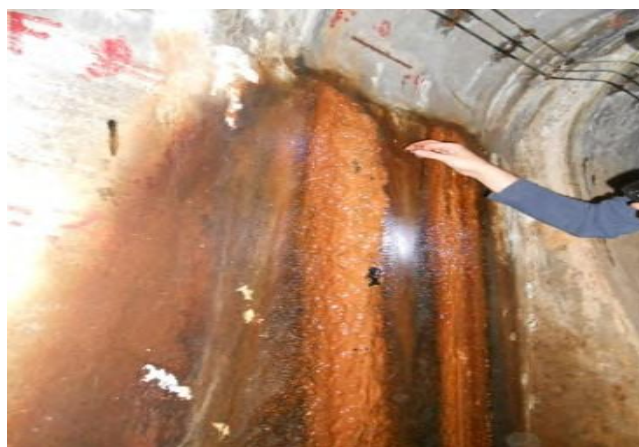
Figure II.24 : Moisissure au niveau de la galerie de visite.
