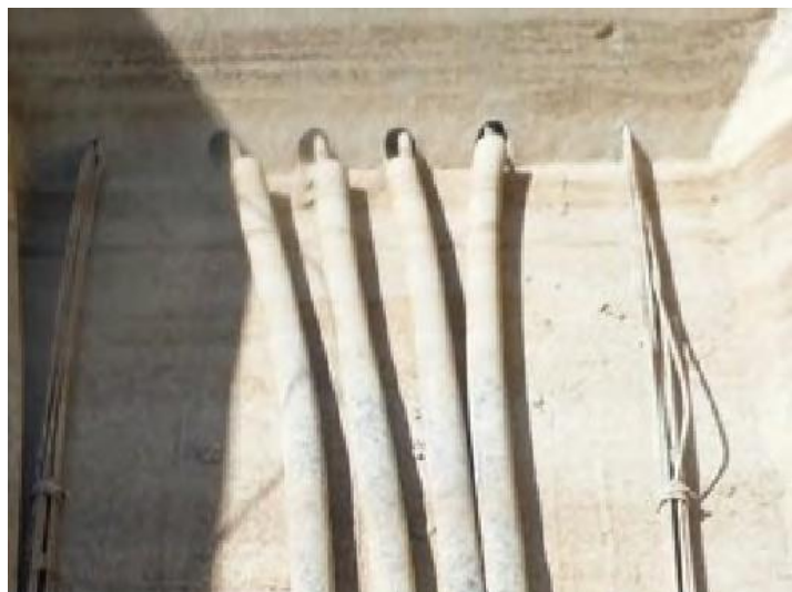
Figure III.62 : Gains désolidarisées du sillon laissant les fils non protégés – absence de coulis.
