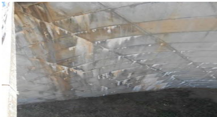
Figure II.14 : Extrusions calcaires au parement aval.
