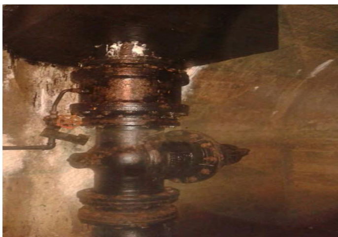
Figure II.34 : Détails de la valve de sécurité du puits de captage.
