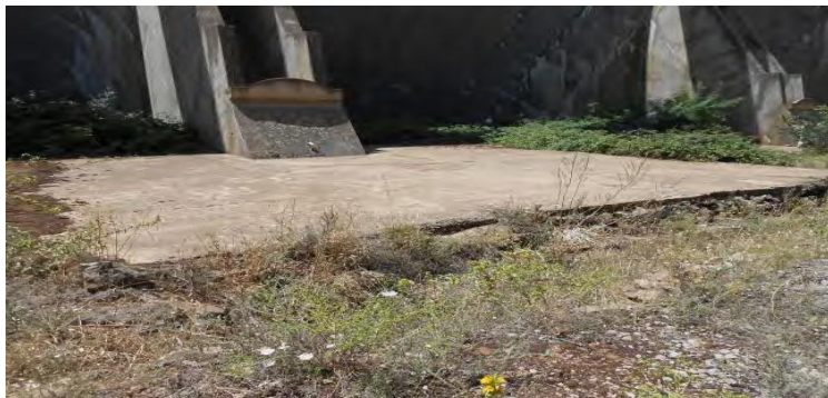
Figure II.17 : Affouillement et érosion remontantes en aval d'une des plaques situées sous les déversoirs.
