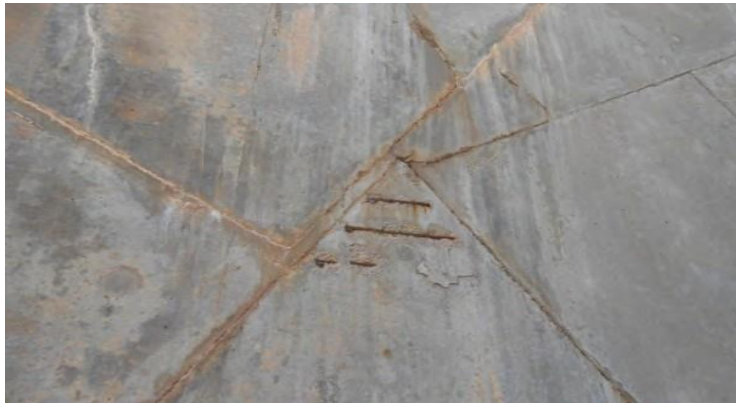
Figure II.16 : Armatures exposées à l'intrados des voutes.
