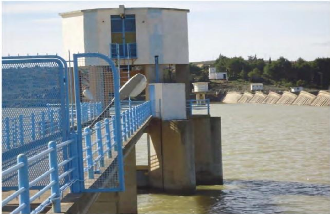
Figure I.6 : Photo de la vanne de décharge intermédiaire
