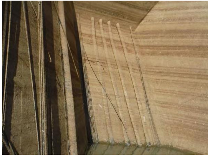
Figure III.54 : Câble gainé entièrement rompu (le câble a disparu).
