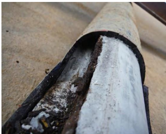
Figure III.57 : Voûte 10-11 - Câble 21 – Vide partiel de coulis et fil corrodé jusqu'à une perte totale de section.
