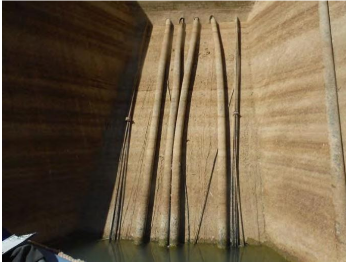
Figure III.61 : Câbles gainés avec courbure, et câbles guipés détendus ou non rectilignes.
