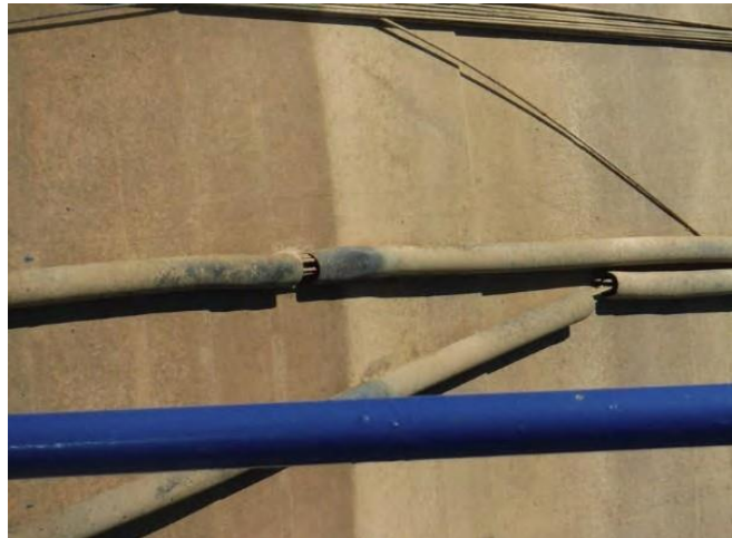
Figure III.52 : Un câble gainé présentant des cassures au droit de la gaine et un câble gainé entièrement rompu, non fonctionnel.
