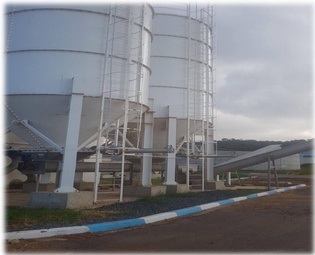
Figure III-8 : le stockage des boues
