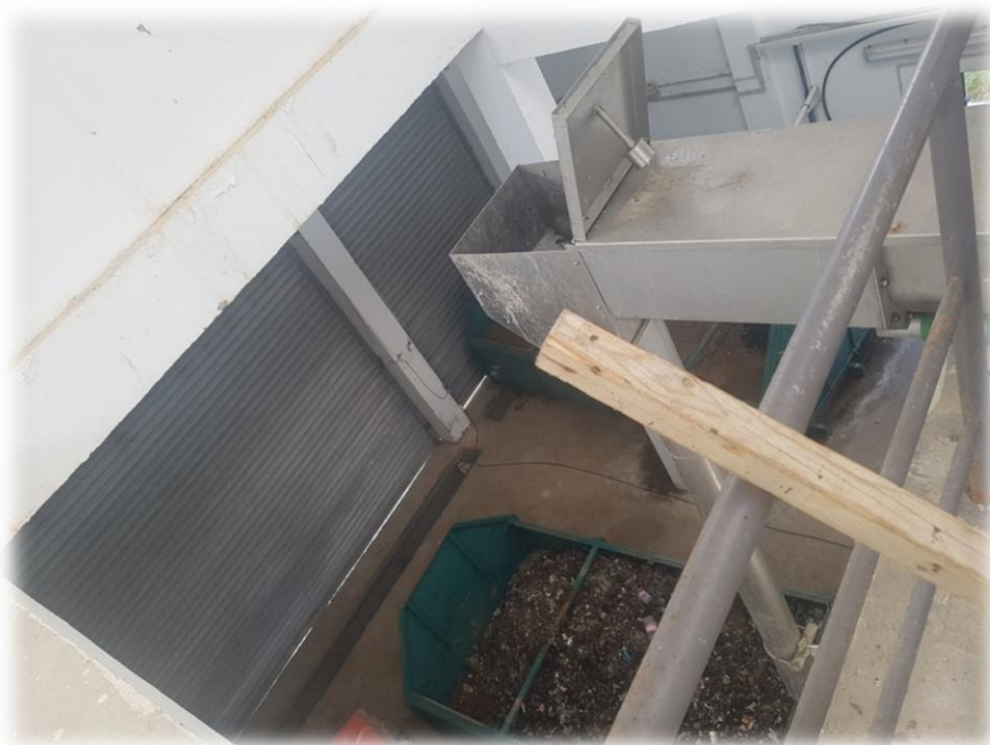
Figure III-2 : le dispositif de nettoyage automatique du dégrillage fin.
