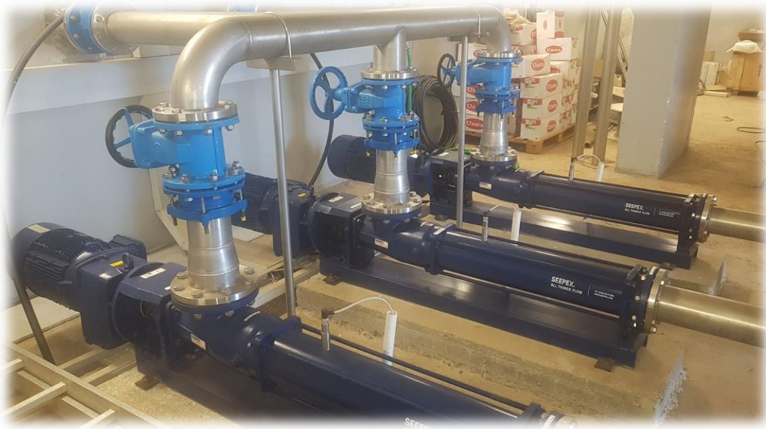
Figure III-7 : Photo illustrant les pompes doseuses d'injections de polymère.
