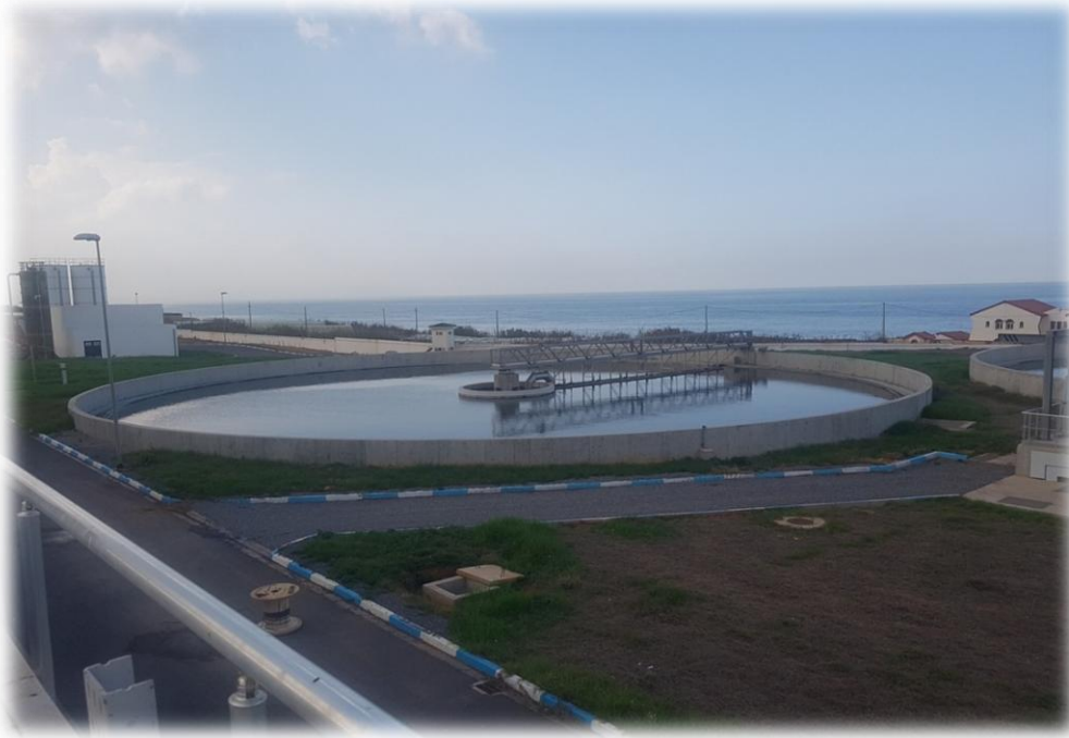
Figure III-5 : Photo illustrant un clarificateur.
