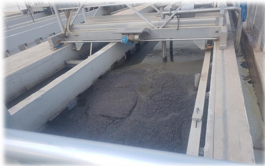
Figure III-3 : Photo illustrant le dessabler / déshuileur.
