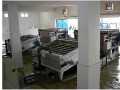
Figure III-12 : différentes images de la machine déshydratation( Source : Step Beni Messous)
