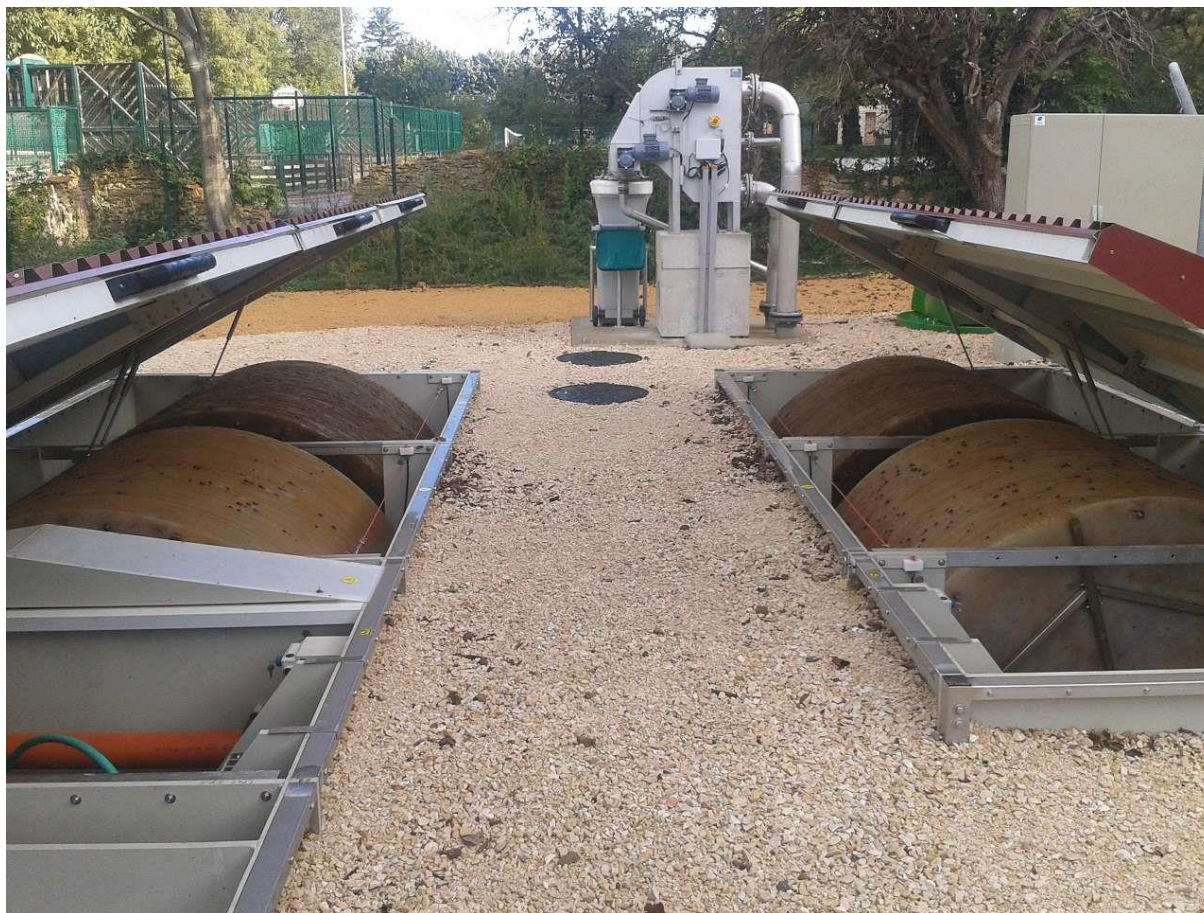
Figure III-6 système de bio-disque enterré « aquacorp »
