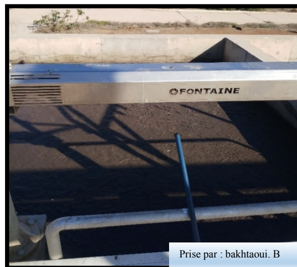
Figure III- 17: Unité de dégazage.
