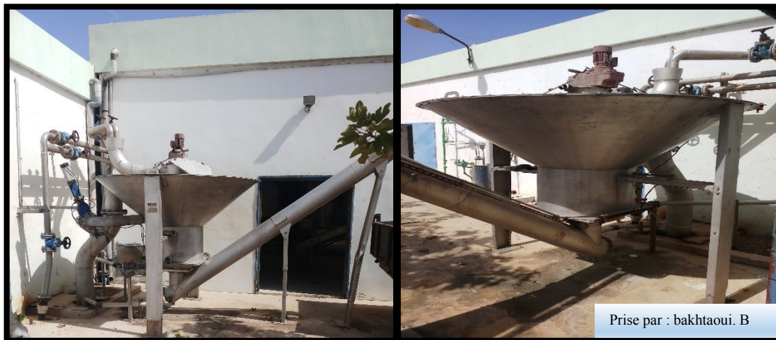
Figure III- 12 : Appareil de lavage des sables.
