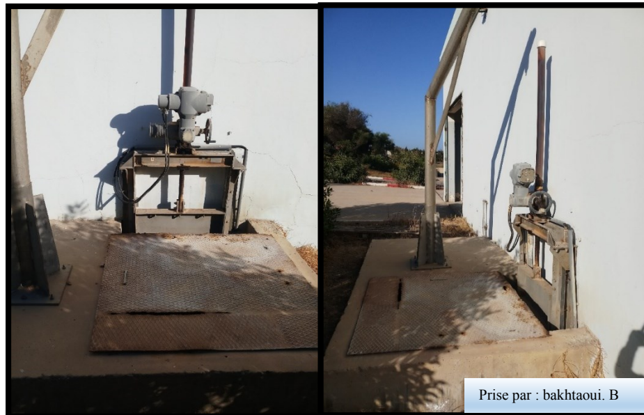
Figure III- 6 : Piège à cailloux équipé d'une vanne murale.
