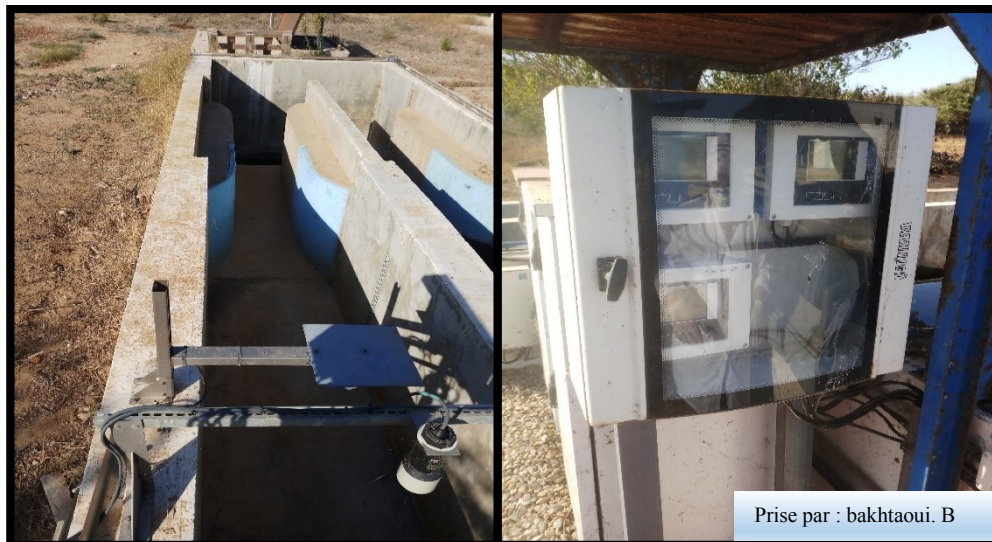
Figure III- 27 : Les appareils d'autocontrôle de débit sortant.
