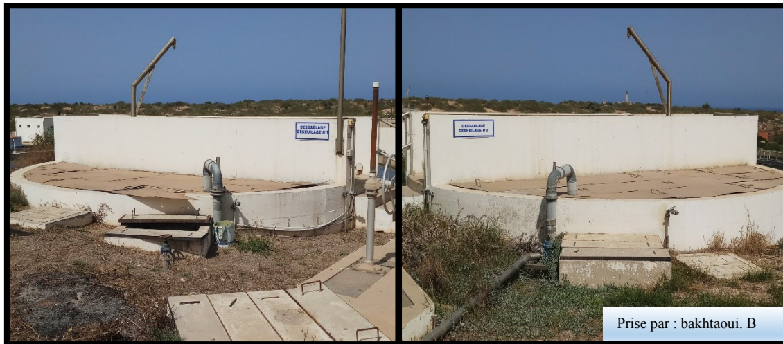
Figure III- 11 : Ouvrages de Dessablage-Dégraissage
