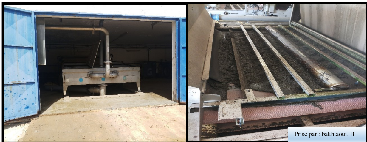
Figure III- 24 : Déshydratation par filtre à bande.
