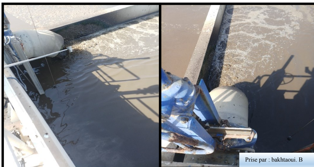
Figure III- 21 : Recirculation dans la zone d'anaérobie.
