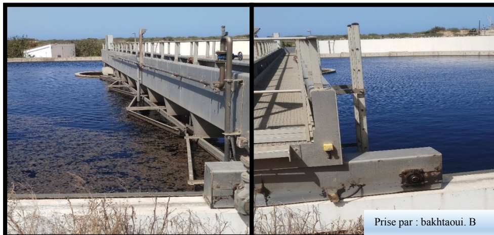
Figure III- 19 : Raclage des flottants en surface
