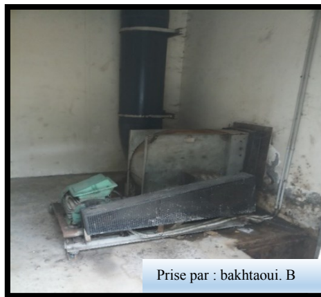
Figure III- 13 : Unité de traitement de l'air vicié
