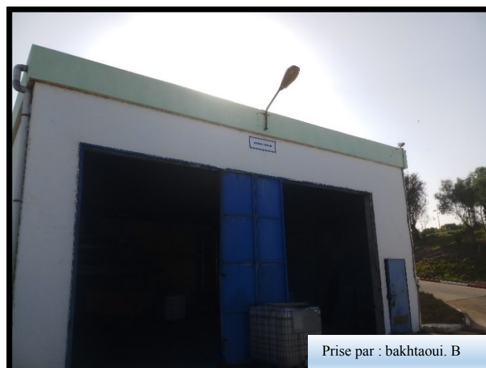
Figure III- 23 : Benne de Stockage des boues déshydratées
