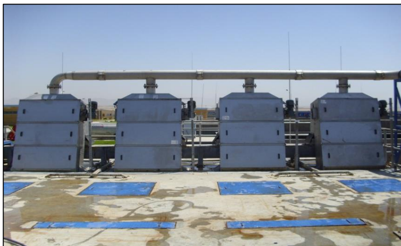
Figure 44 Les dégrilleurs (STEP Elkarma)
