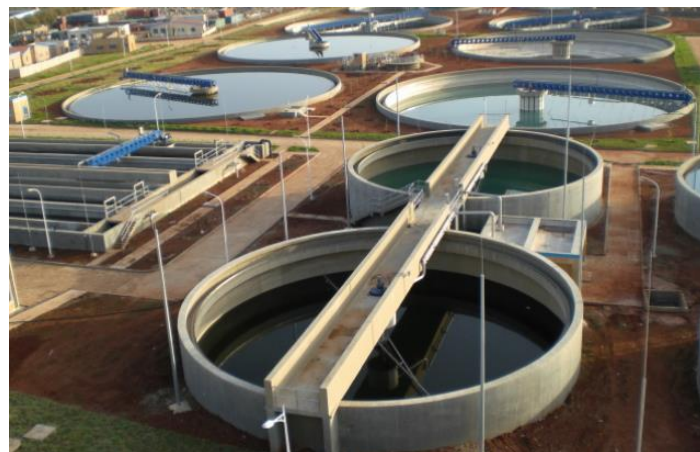
Figure 52 Bassin d'homogénéisation de la boue (STEP Elkarma)
