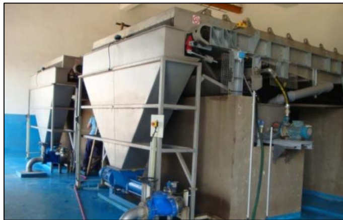
Figure 53 Table d'égouttage (STEP Elkarma)
