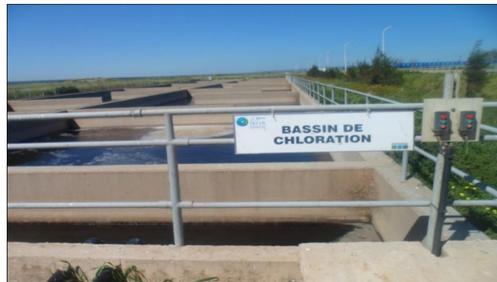
Figure 50 Bassin de chloration (STEP El karma)
