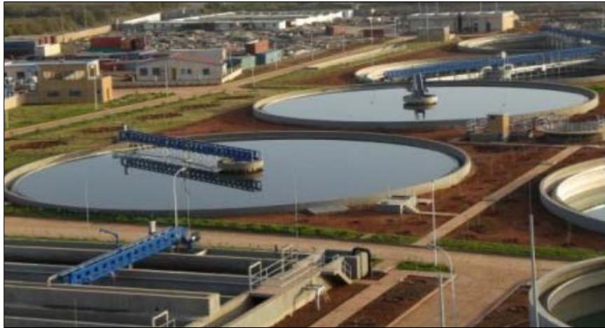
Figure 47 Décanteur primaire (photo prise des bacs de stockage des boues) (STEP Elkarma)
