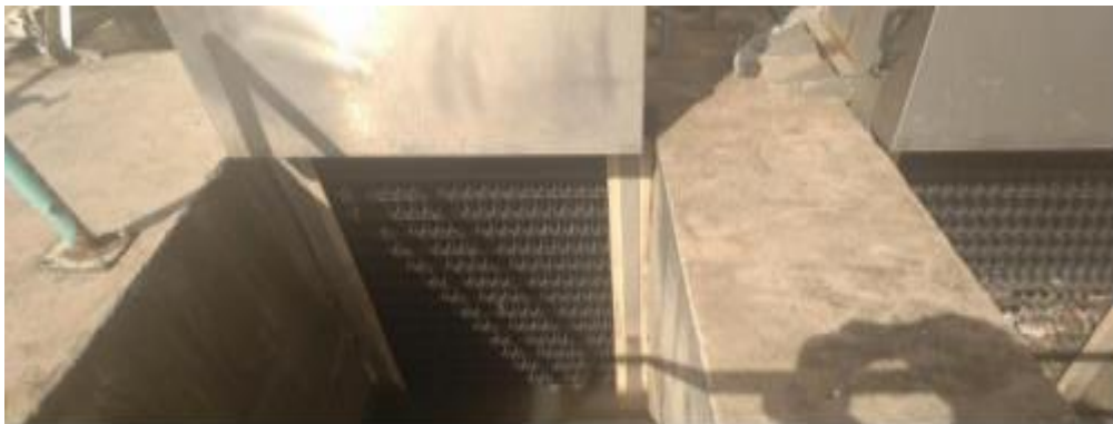
Figure II.3: Dégrilleur automatique de la STEP de Médéa.
