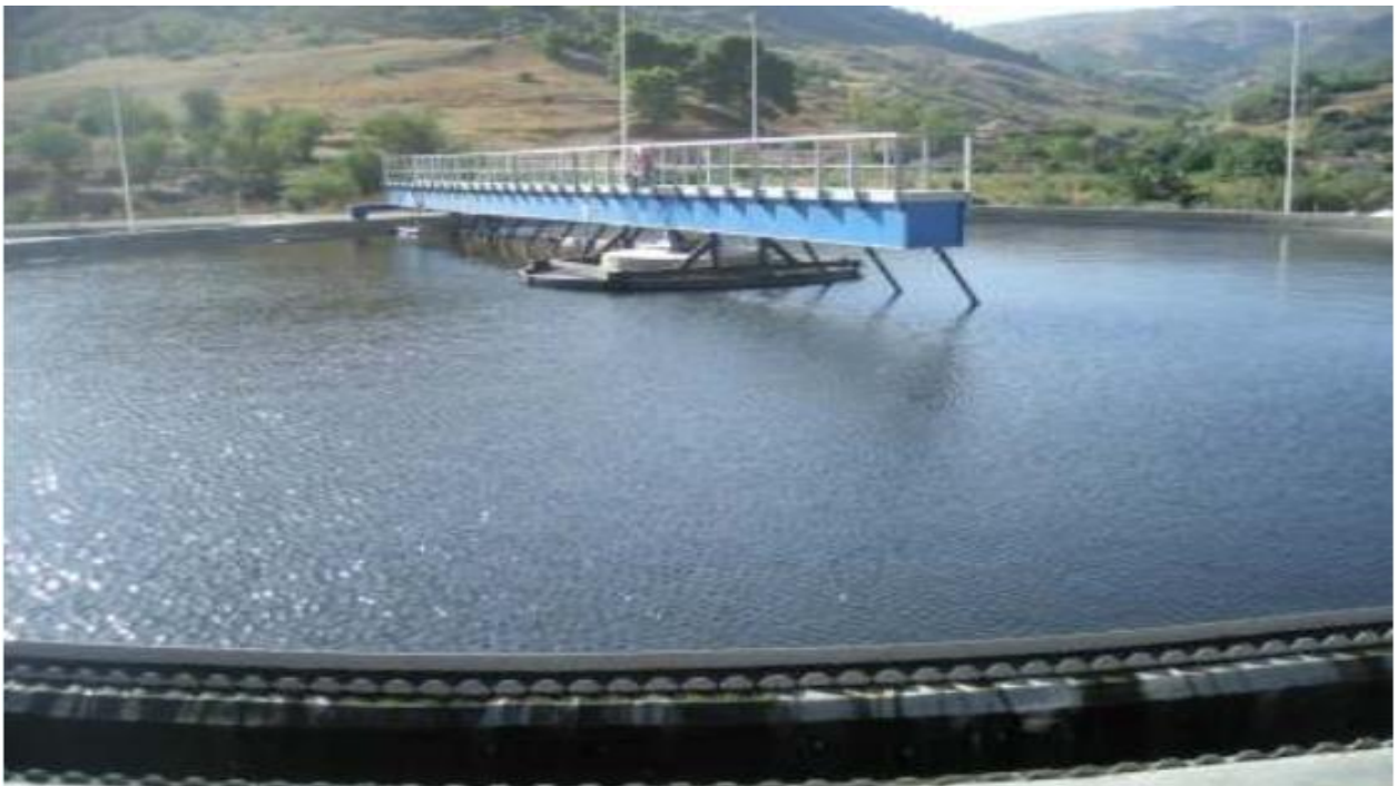
Figure II.6: Décanteur de la STEP de Médéa.
