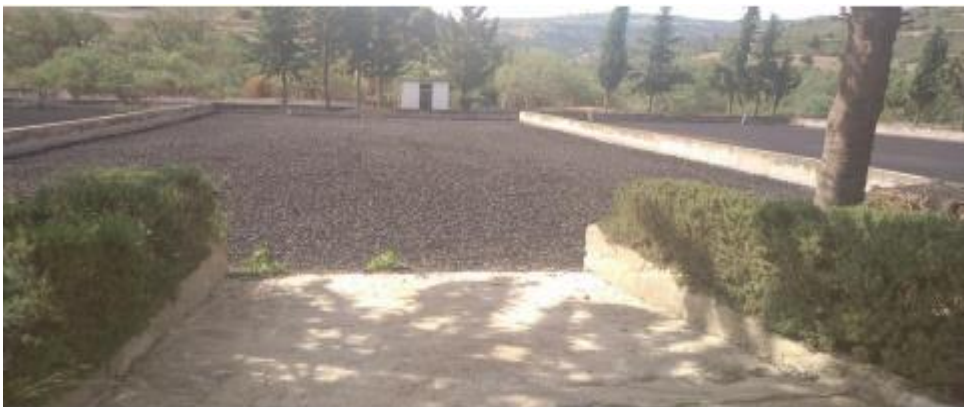
Figure II.9 : Lits de séchage de la STEP de Médéa.
