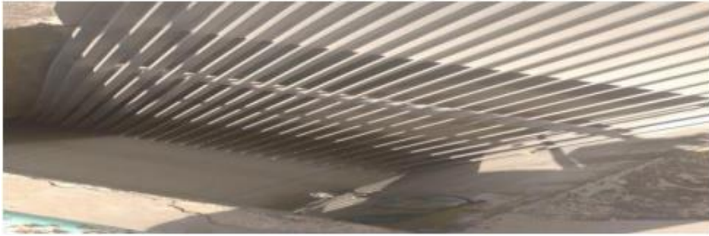
Figure II.2: Dégrilleur mécanique de la STEP de Médéa
