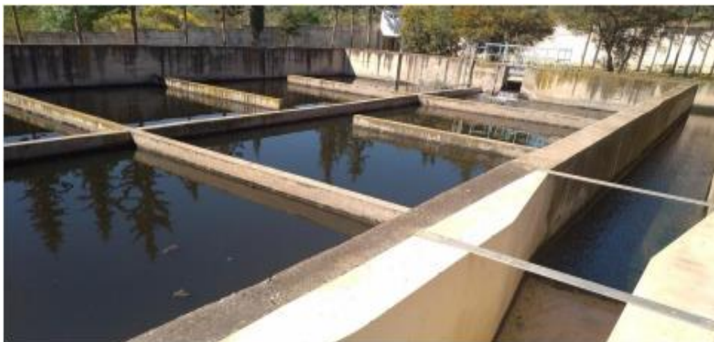
Figure II.7: Bassin de chloration de la STEP de Médéa.
