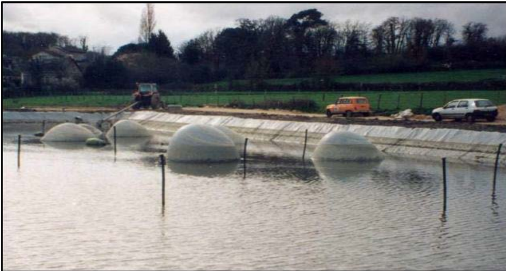
Figure XI.1 : Gonflement de la géomembrane.
