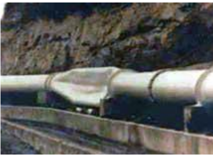
Figure 5 : Conduite endommagée par un coup de bélier
