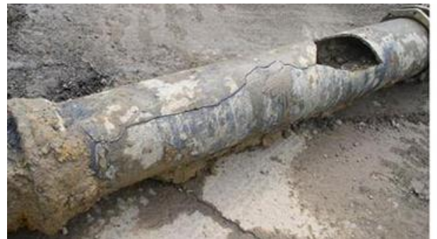
Figure 6 : Conduite en fonte rompue suite à un coup de bélier
