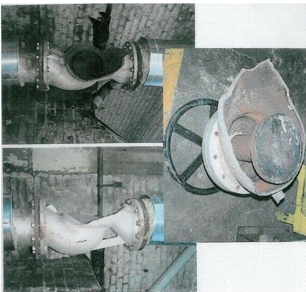
Figure 7 : Rupture d'équipements suite à un choc hydraulique
