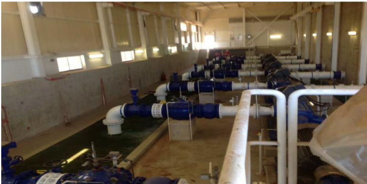
Figure III-10: Station de pompage d'eau traitée.
