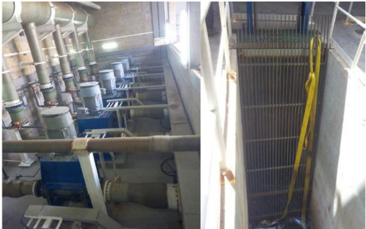
Figure III-2: Le dégrilleurs et la station de pompage.
