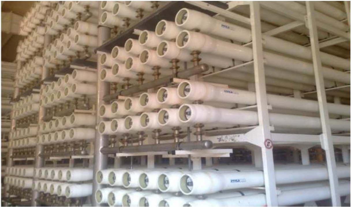
Figure III-6: Unité d'osmose inverse.
