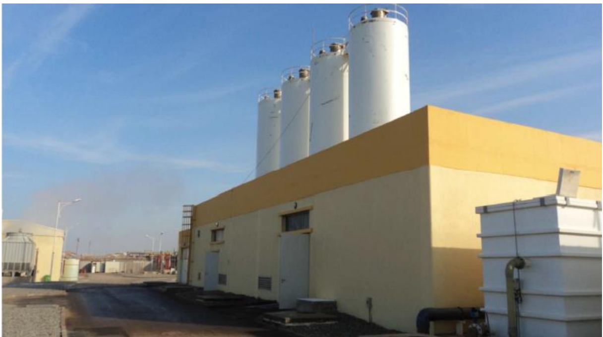
Figure III-8: Silos de la chaux.
