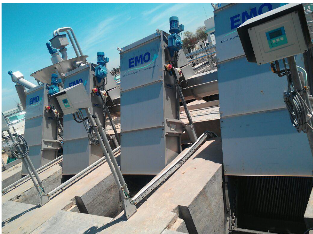
FIGURE 3.4 – Dégrilleurs automatiques de la STEP de Béni Mered
