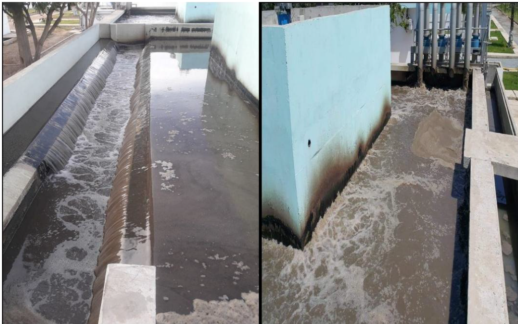
FIGURE 3.9 – Bassin d'aération de la STEP de Béni Mered
