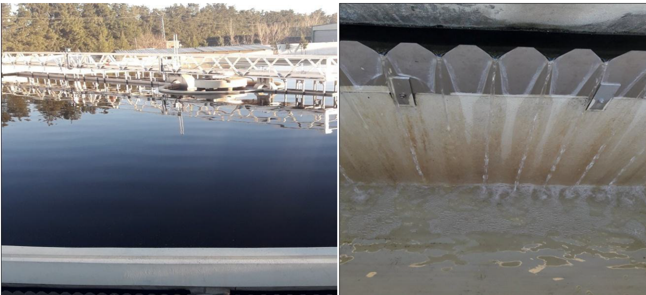
FIGURE 3.10 – Clarificateur de la STEP de Béni Mered
