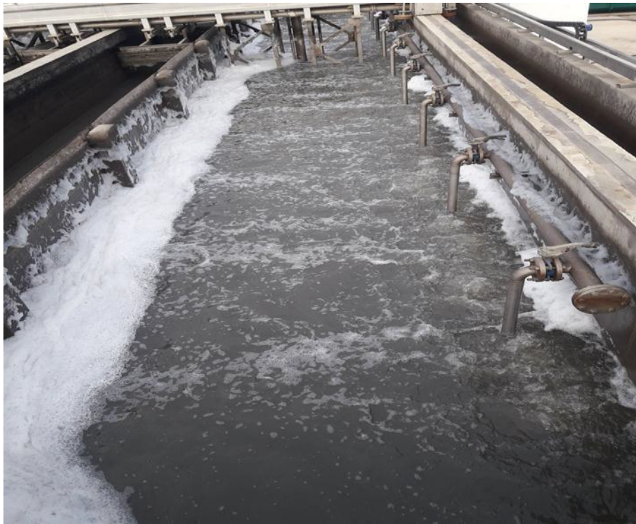
FIGURE 3.5 – Déssableur-dégraisseur de la STEP de Béni Mered
