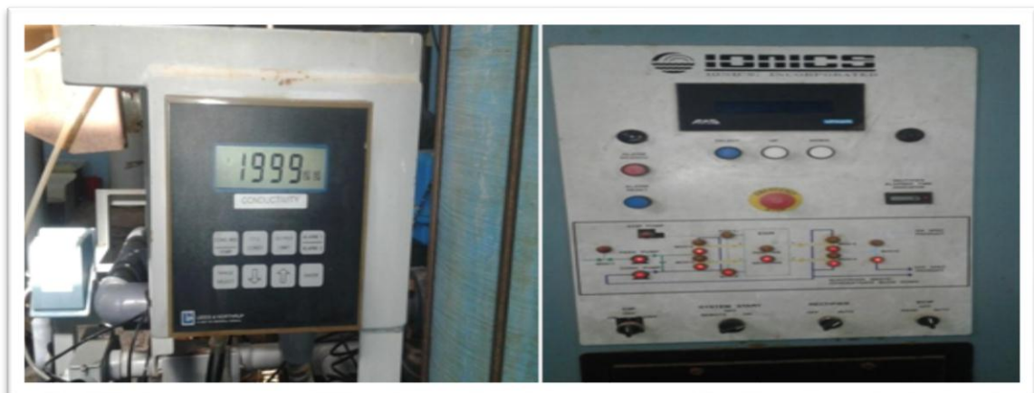
Figure IV .6 : conductimètre et la vanne électrique de station électrodialyse.
