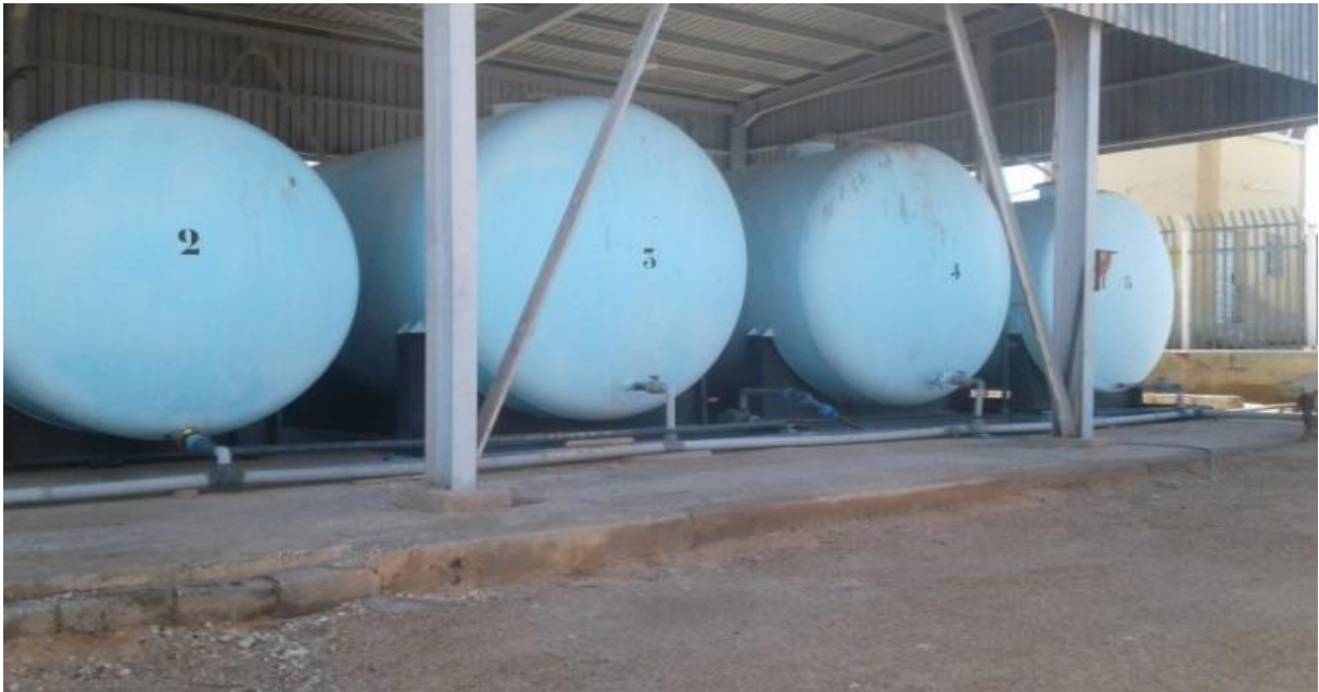
Figure 03 : réservoir de d'eau traité
