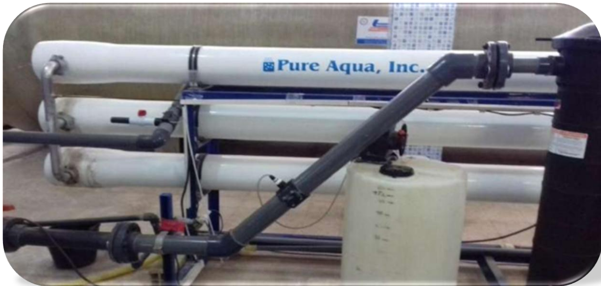
Figure IV .4 : Membranes d'osmose inverse (Station Sarl Ben Amor)
