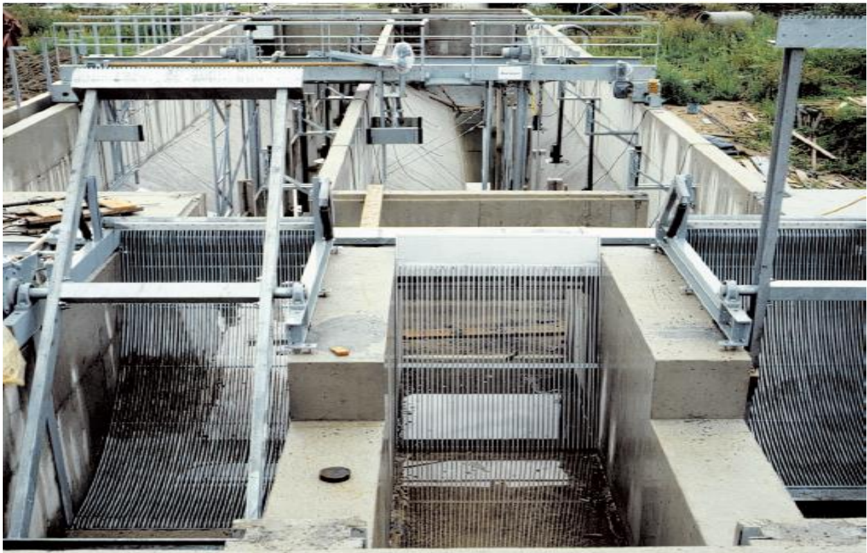
Figure 7: Dégrilleur automatique Source : STEP de la wilaya de Guelma
