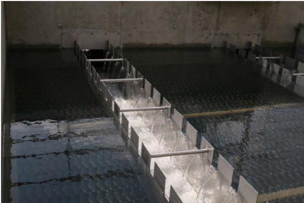
Figure III.6 : Canaux collecteurs d'eau à l'intérieur de décanteur
