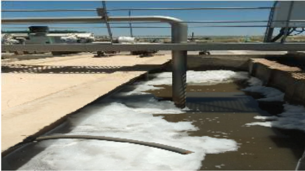
Figure II.4: Dégrossisseur. (Mr. BOUCELHA M Mr. HIDRA H 2018 – 2019)
