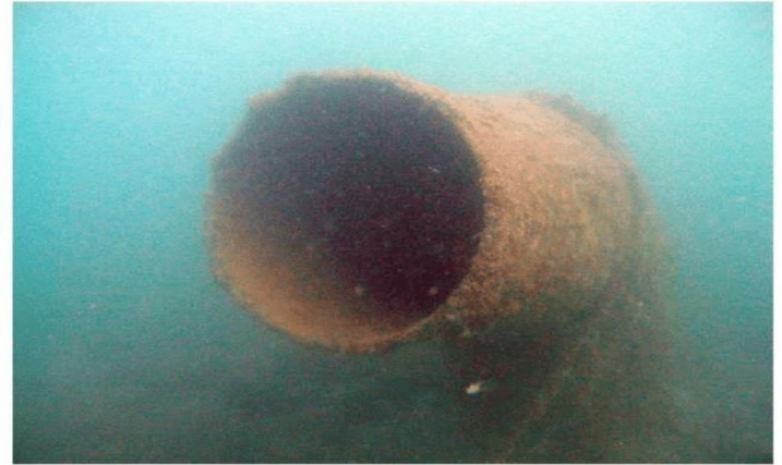
Figure III- 2 Diffuseur de rejet de saumure
