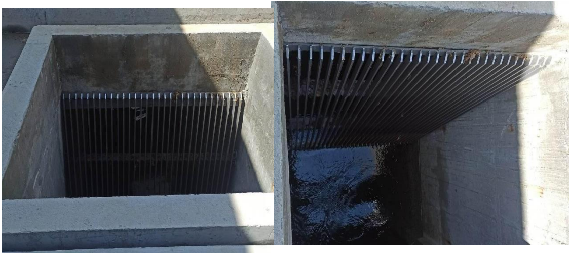
Figure IV- 4 Dégrilleur grossiers d'El Marsa
