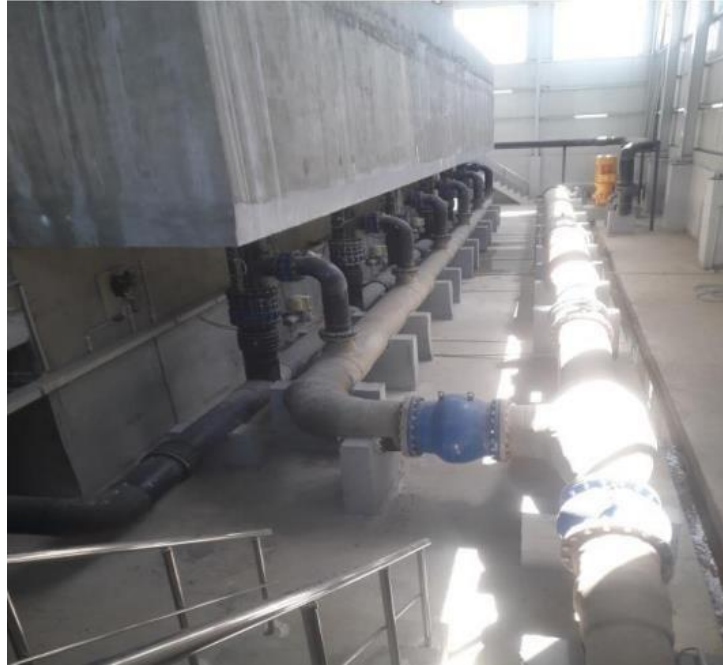
Figure IV- 21 le réservoir de reminéralisation LEOPOLD
