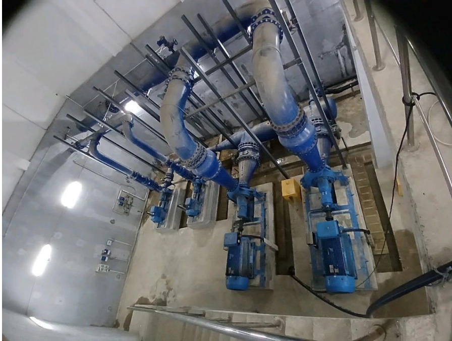
Figure IV- 23 Station de pompage d'eau traitée
