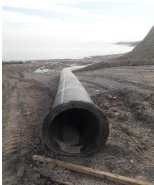
Figure IV- 3 La conduite de captage
