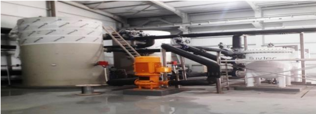
Figure IV- 19 Le système de nettoyage des membranes unité CIP
