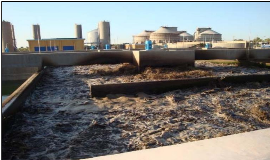
Figure III.4 : Bassin d'aération (Source :STEP BOUFARIK)
