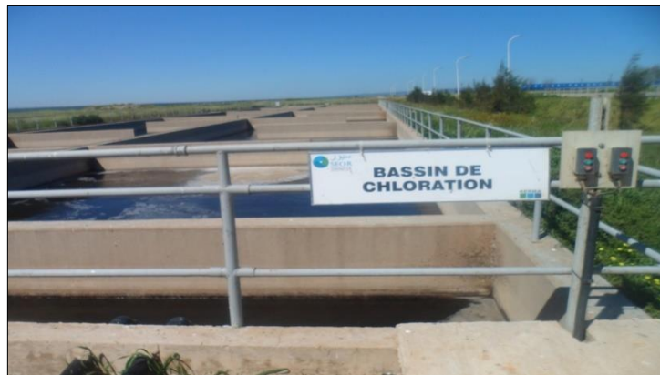
Figure III.6 : Bassin de chloration (Source :STEP BOUFARIK)
