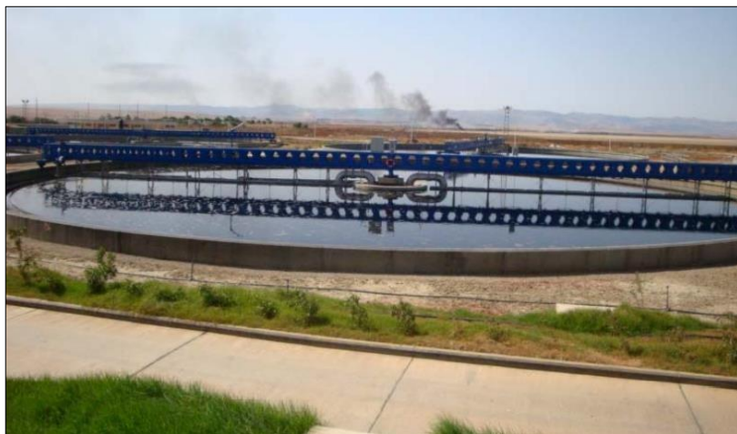
Figure III.5 : Décanteur secondaire (Source :STEP BOUFARIK)
