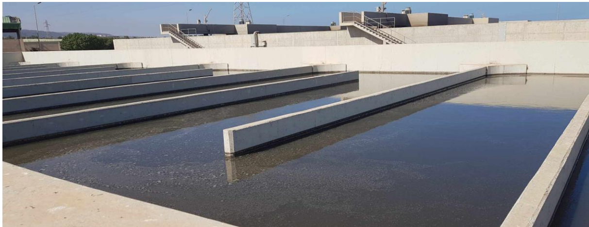
Figure III.13 : Bassin de désinfection
