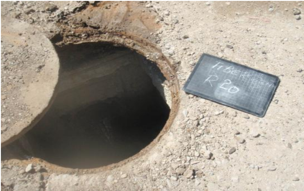
FigureV.3 : regard en mauvais état (avril,2022)
