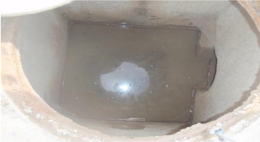
Figure V. 2 : regard en bon état (avril,2022)
