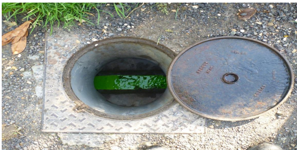
Figure V.1 : regard 21 en bon état (avril,2022)
