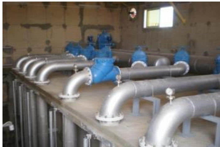
Figure III. 11 : La chambre de pompage et relevage.
