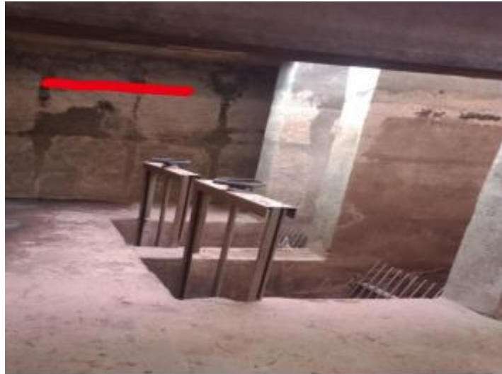
Figure IV. 3 : Chambre de contrôle.
