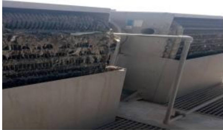
Figure III. 12 : Les deux dégrilleurs fins.
