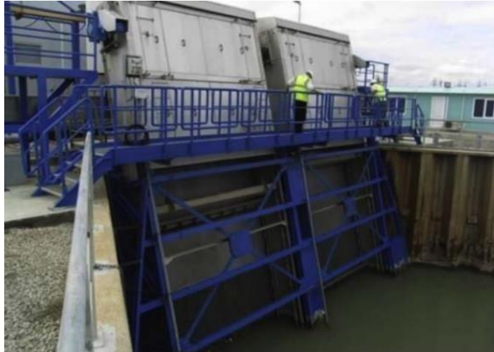
Figure III.2. Cribles grossiers de prise à terre
