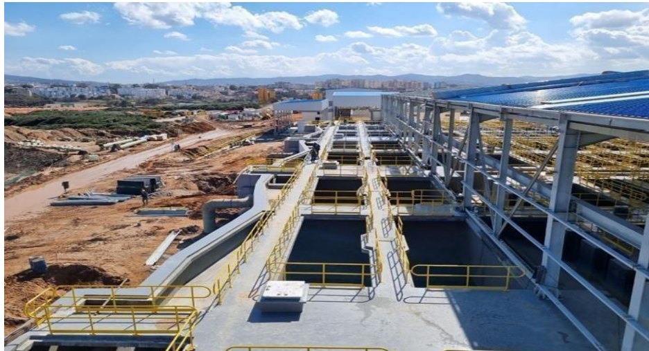
Figure.IV.2. Clarificateur de la station de dessalement de corso en cours de construction
