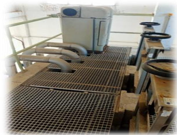
Figure III. 3: le dégrilleur fin
