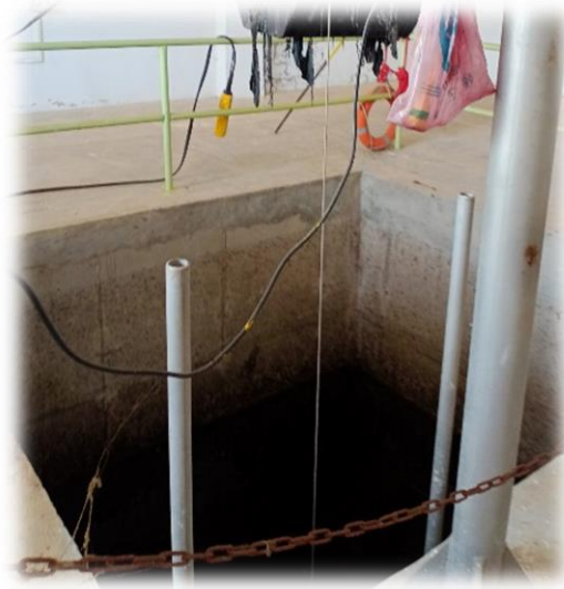
Figure III. 2: le dégrilleur grossier
