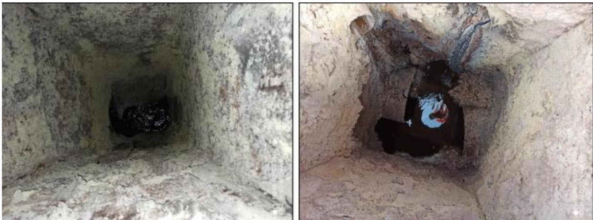
Figure III.6 : Dégradation des parois des regards accuse de dégagement de H 2 S
