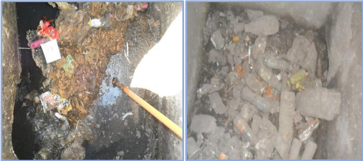
Figure II. 3:Des regards colmaté.
