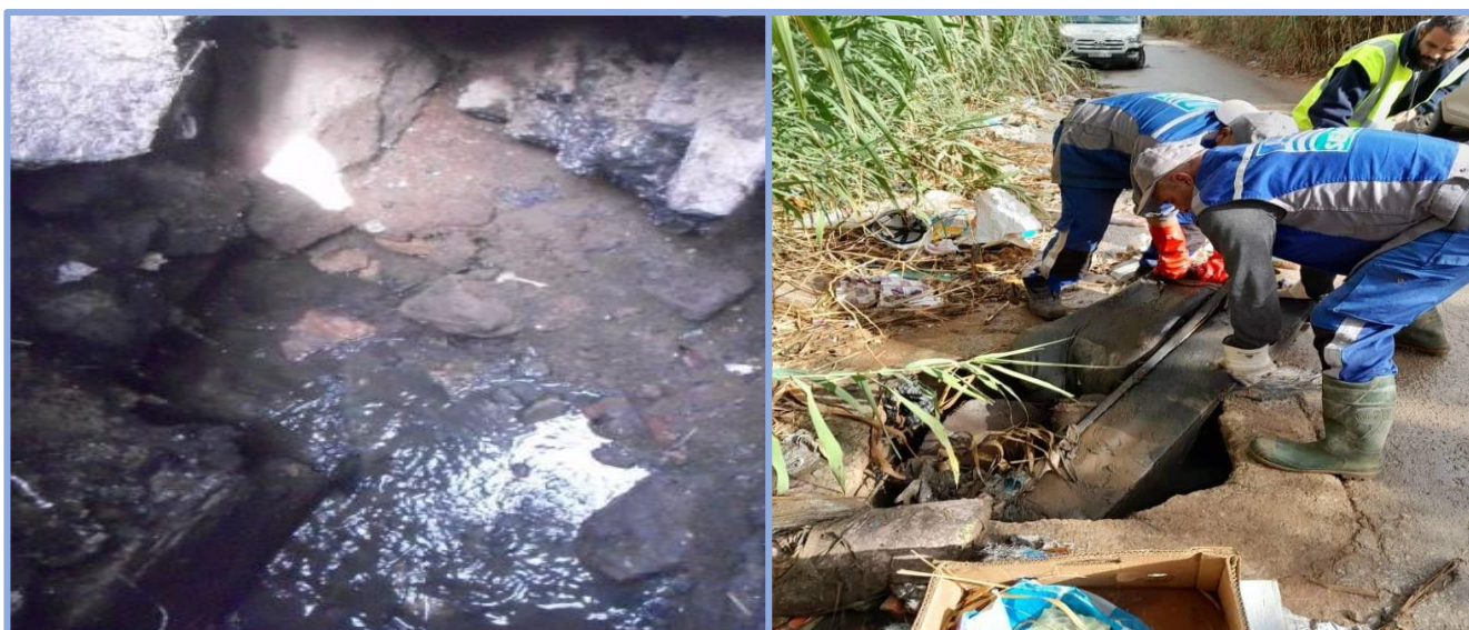
Figure II. 2:des regards en état dégradée
