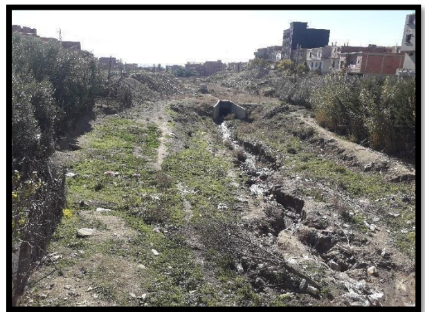
Figure II. 2 : Partie non aménagée d'oued Nessissa.
