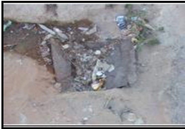
Figure II. 9 : Bouche d'égout colmatée.
